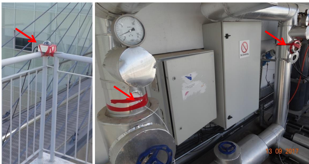
Σχήμα 8-9: Σημεία τοποθέτησης αισθητηρίου ακτινοβολίας (αριστερά) και αισθητηρίων θερμοκρασίας λαδιού (δεξιά) του φορητού εξοπλισμού
