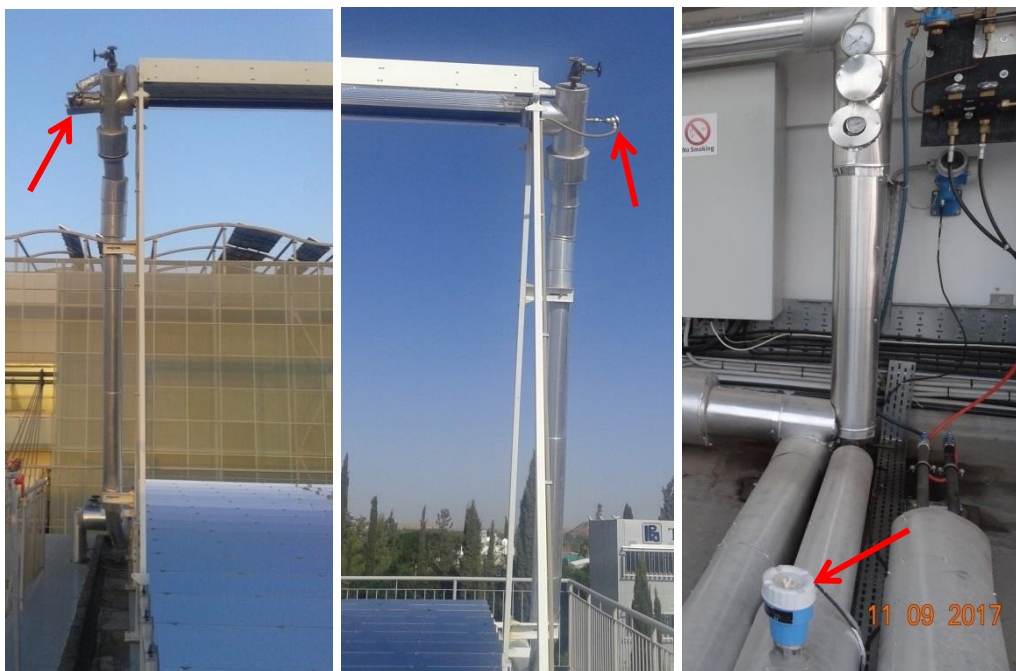
Σχήμα 8-6: Αισθητήρα θερμοκρασίας θερμικού λαδιού στην έξοδο (αριστερά) και είσοδο του ηλιακού συλλέκτη (κέντρο) και ροόμετρο (δεξιά)
