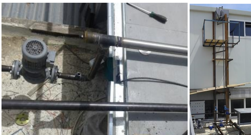
Σχήμα 7-8: Κυκλοφορητής, ηλεκτρική αντίσταση και δοχείο διαστολής θερμικού λαδιού
