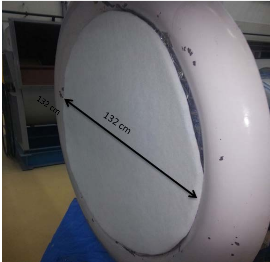
Σχήμα 2.31: Τοποθέτηση φίλτρου αέρα στον αγωγό εισόδου της εγκατάστασης
