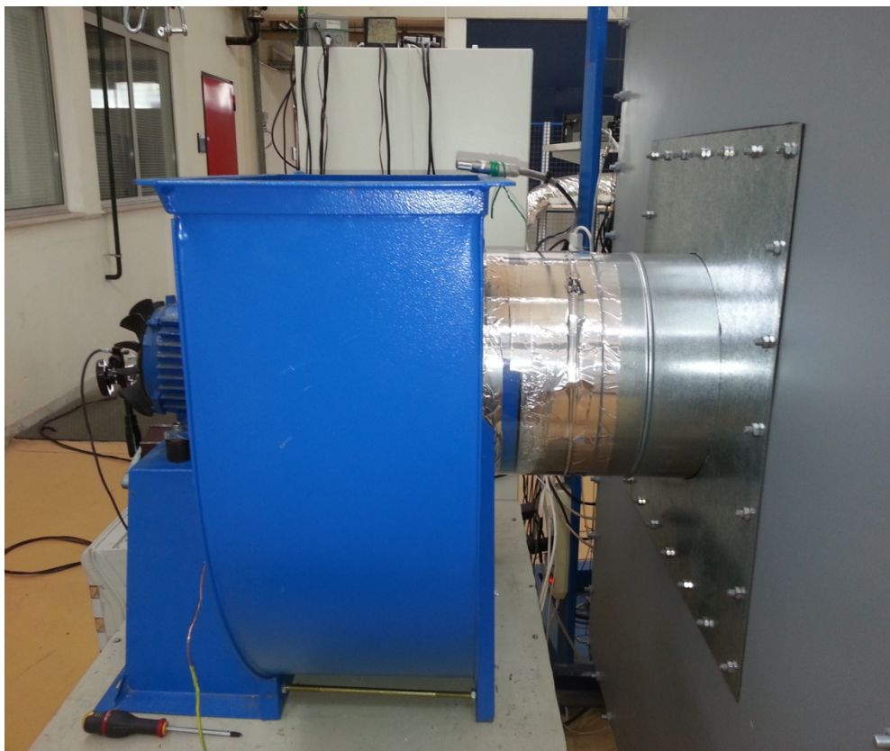
Σχήμα 6.3 : Ο προς μέτρηση φυσητήρας-σύνδεση με την εγκατάσταση
