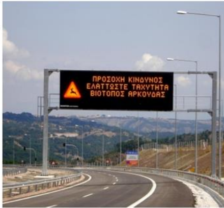
Σχήμα 2.1: Σταθερή Πινακίδα Μεταβλητών Μηνυμάτων (Πηγή: ecology-salonica.org)
