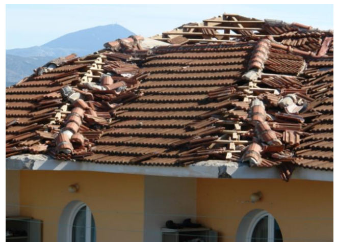
Εικόνα 2.9α,2.9β : Απώλεια τμήματος της επικάλυψης λόγω σεισμού, Κεφαλονιά, 2014 [27]
