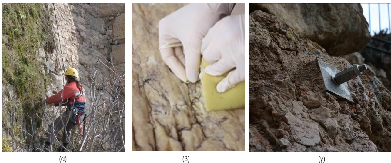
Εικόνα 45: (α) Διεξαγωγή αποψίλωσης, (β) Καθαρισμός επιφάνειας, (γ) Στερέωση με βλήτρο Πηγές: (α) & (β) Αρχείο ΥΣΜΑ www.ysma.gr , (γ) προσωπικό αρχείο συγγραφέα
