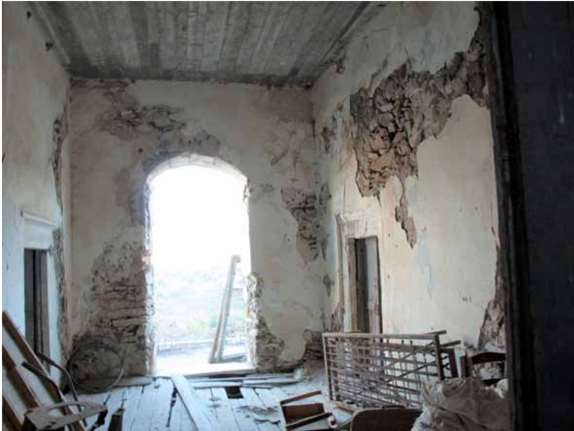
Φ.71. Ο χώρος 204 (σάλα) όπου διακρίνεται το μεγάλο τοξωτό άνοιγμα Θ_208, το μεταγενέστερο ξύλινο πάτωμα που είναι υπό καταρρευση και της δύο θύρες που οδηγούν στα υπόλοιπα δωματια.
