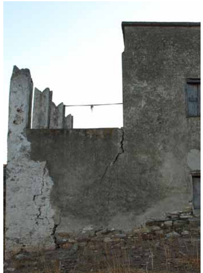
εικ. 45. Βόρεια όψη όπου φαίνονται οι έντονες ρωγμές από την καθίζηση και την έλλειψη σύνδεσης των δυο φάσεων
