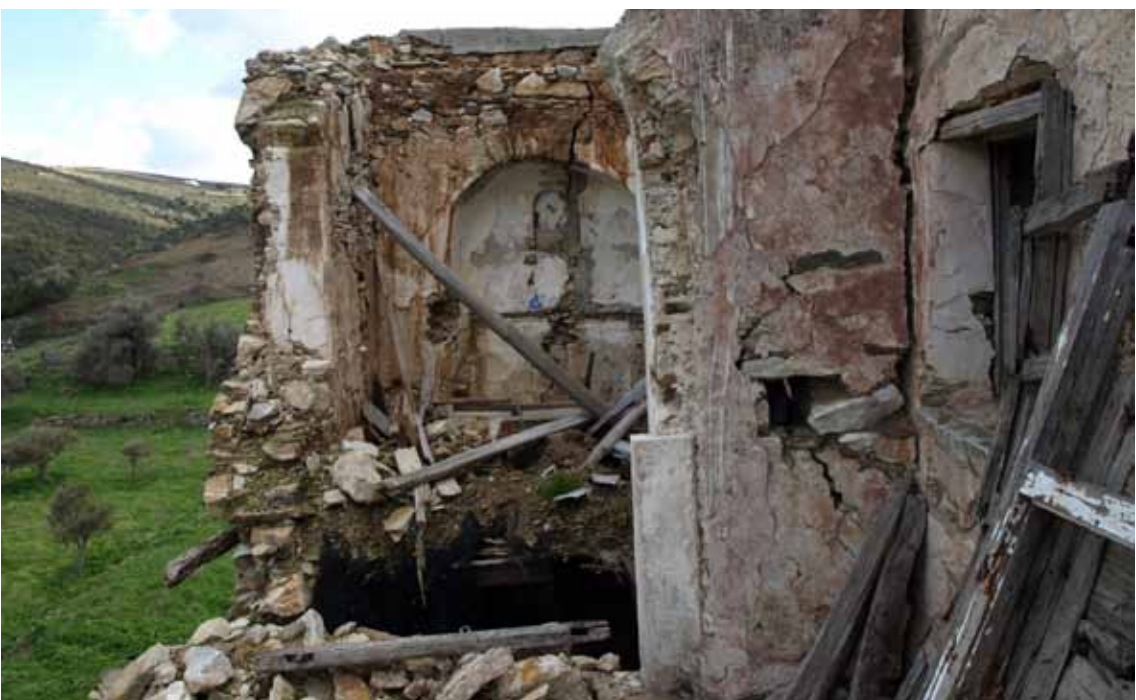
Φ.82. Το παρεκκλήσι στον όροφο όπου μεγάλο τμήμα του έχει καταρρεύσει
