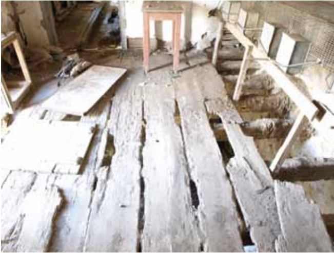
εικ 17. Δάπεδο με σανίδες υπο κατάρρευση στον χώρο 206 του ορόφου
