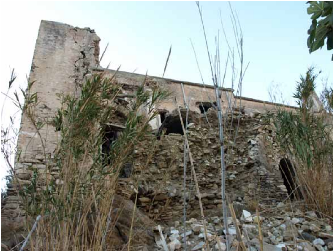
Φ.52. Ανατολική όψη. Η εξωτερική παρειά της λιθοδομής έχει καταρρεύσει
