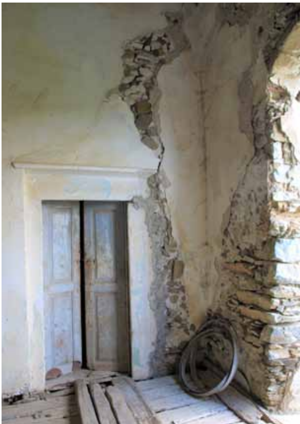
Φ.72. Η θύρα Θ_209 είναι η αρχική κεντρική θύρα του ορόφου όπως διαπιστώθηκε με την ανάλυση των φάσεων και είναι η μόνη εσωτερική θύρα με μαρμάρινο περιθύρωμα και γείσο
