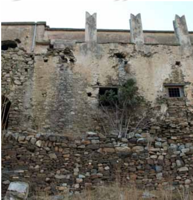
εικ. 38. Ανατολική όψη όπου αριστερα διακρίνεται ο κατασκευαστικός αρμός, ενώ δεξιά η θύρα που έχει μετατραπεί σε παράθυρο
