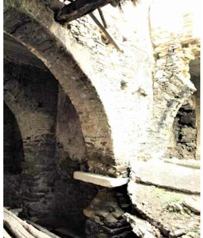
εικ. 49. Χώρος 101 όπου φαίνεται η αποσάρθρωση της βάσης του τόξου
