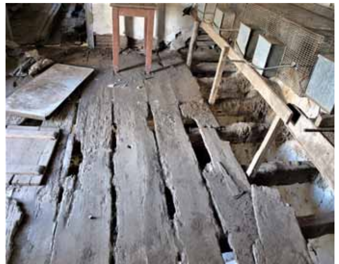
εικ. 51. Αποσαρθρωμένο ξύλινο δάπεδο στον χώρο 206 του ορόφου
