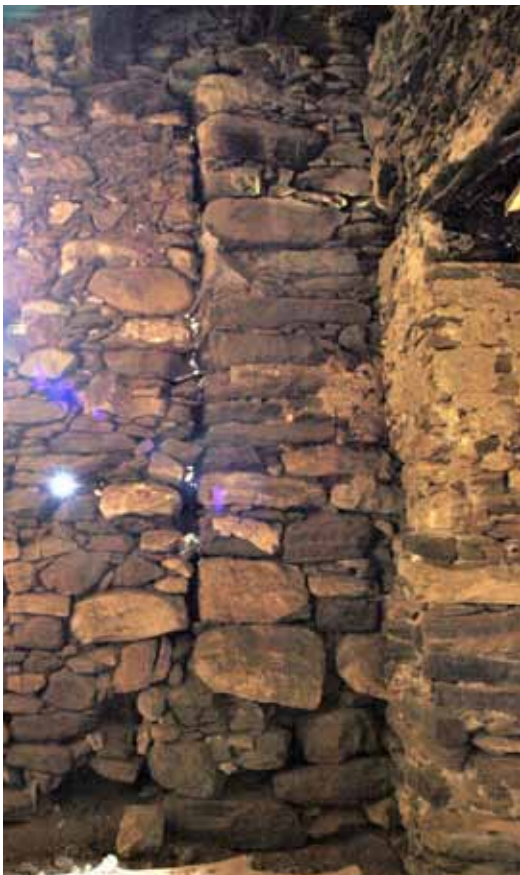
Φ.97. Στον χώρο 108 στον βόρειο τοίχο διακρίνεται ο κατασκευαστικό αρμός της πρώτης φάσης του κτιρίου
