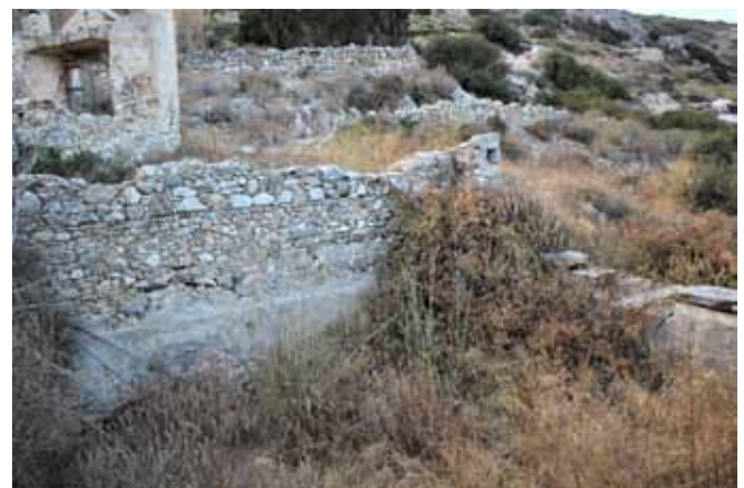
εικ. 63. Η δεξαμενή στην κεντρική Πύλη σε ερειπίωδη κατάσταση
