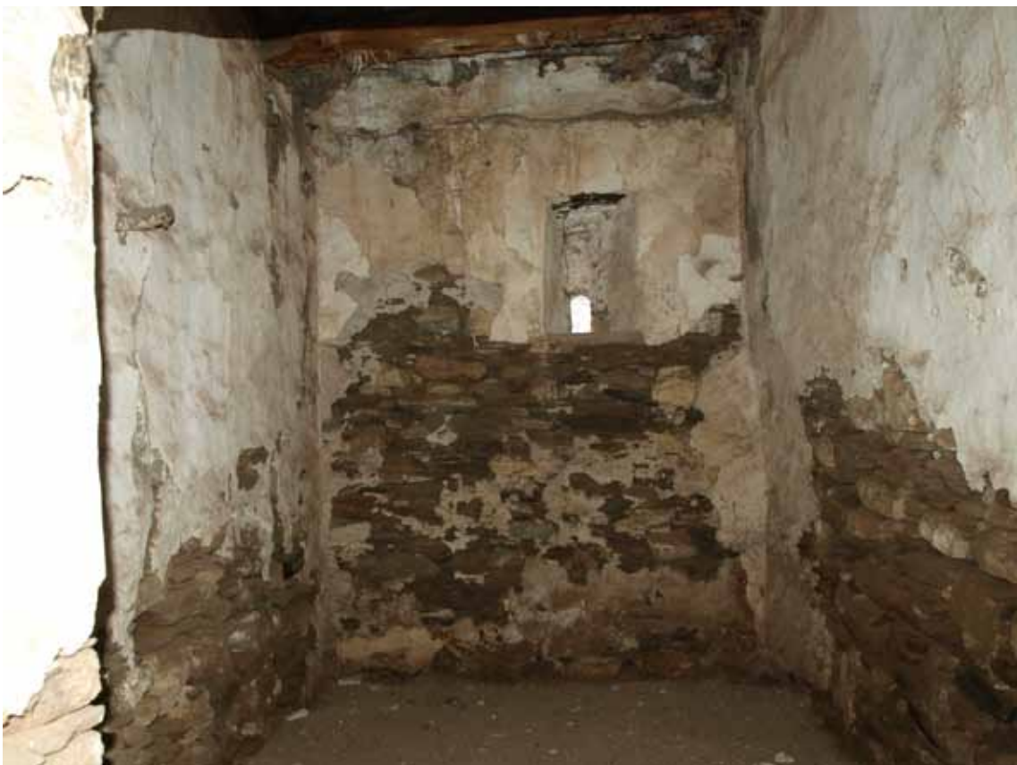
Φ.94. Ο χώρος 104 στον οποίο το παλιό παράθυρο μετατράπηκε σε τυφεκιοθυρίδα. Η ανερχόμενη υδρασία έχει διαβρώσει το επίχρισμα και μέχρι ένα ύψος έχει αποκολληθεί
