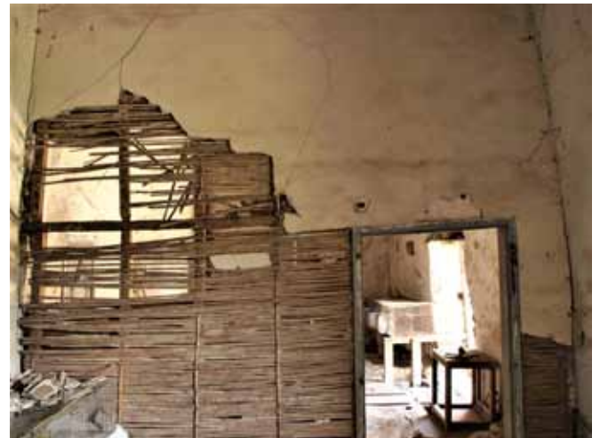
εικ. 50. Μπαγδατότοιχος στον όροφο σε κακή κατάσταση
