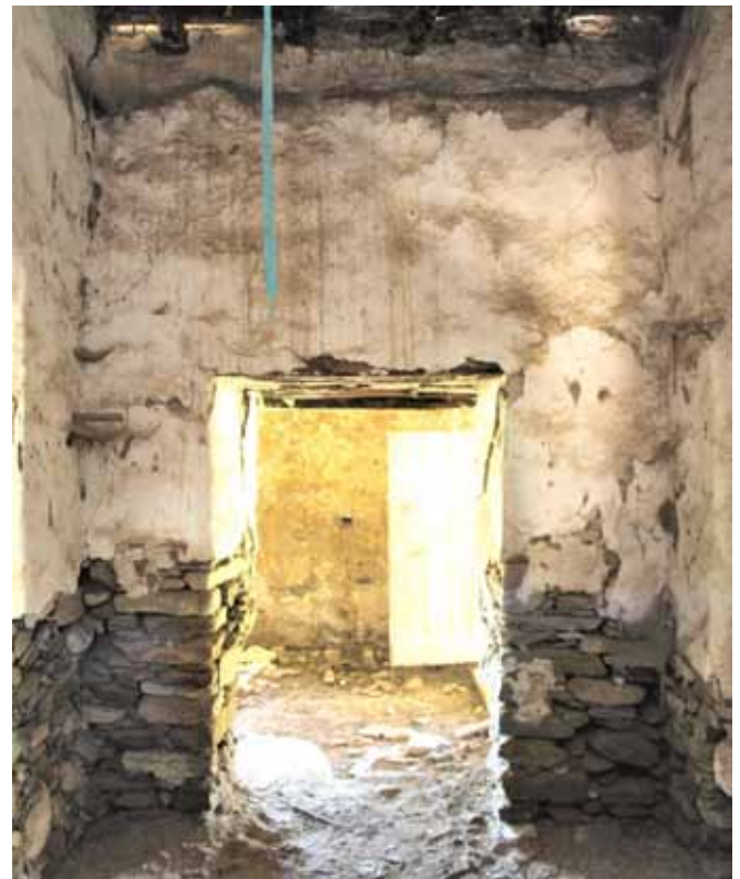
εικ. 48. Αποκόλληση επιχρίσματος λόγω της ανερχόμενης τριχοειδούς υγρασίας
