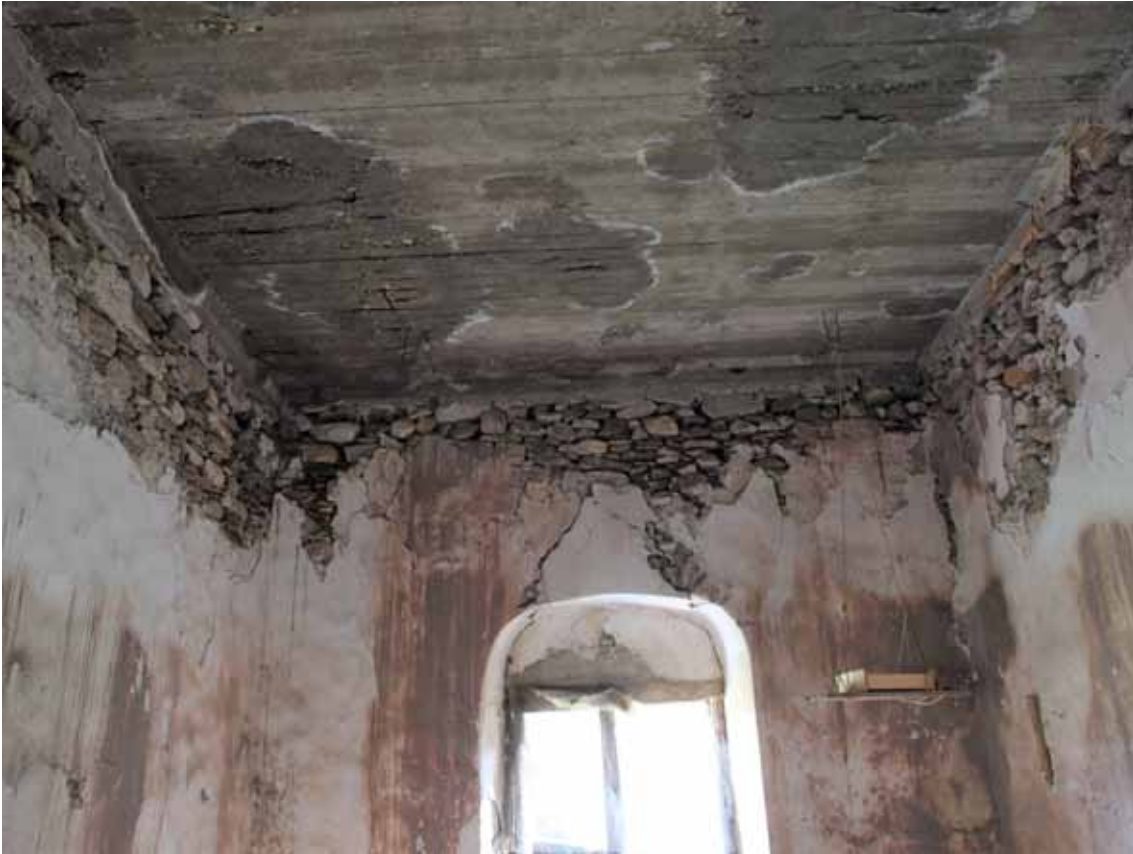
Φ.68. Στον χώρο 203 φαίνεται η οροφή από εμφανές οπλισμένο σκυρόδεμα. Η εμφανής υγρασία στην οροφή διαβρώνει τον οπλισμό της και περιμετρικά στο επάνω τμήμα των τοιχοποιιών έχει αποκολληθεί το επίχρισμα. Επίσης διακρίνονται οι διαγώνιες ρωγμές στο τόξο του παραθύρου Π_202
