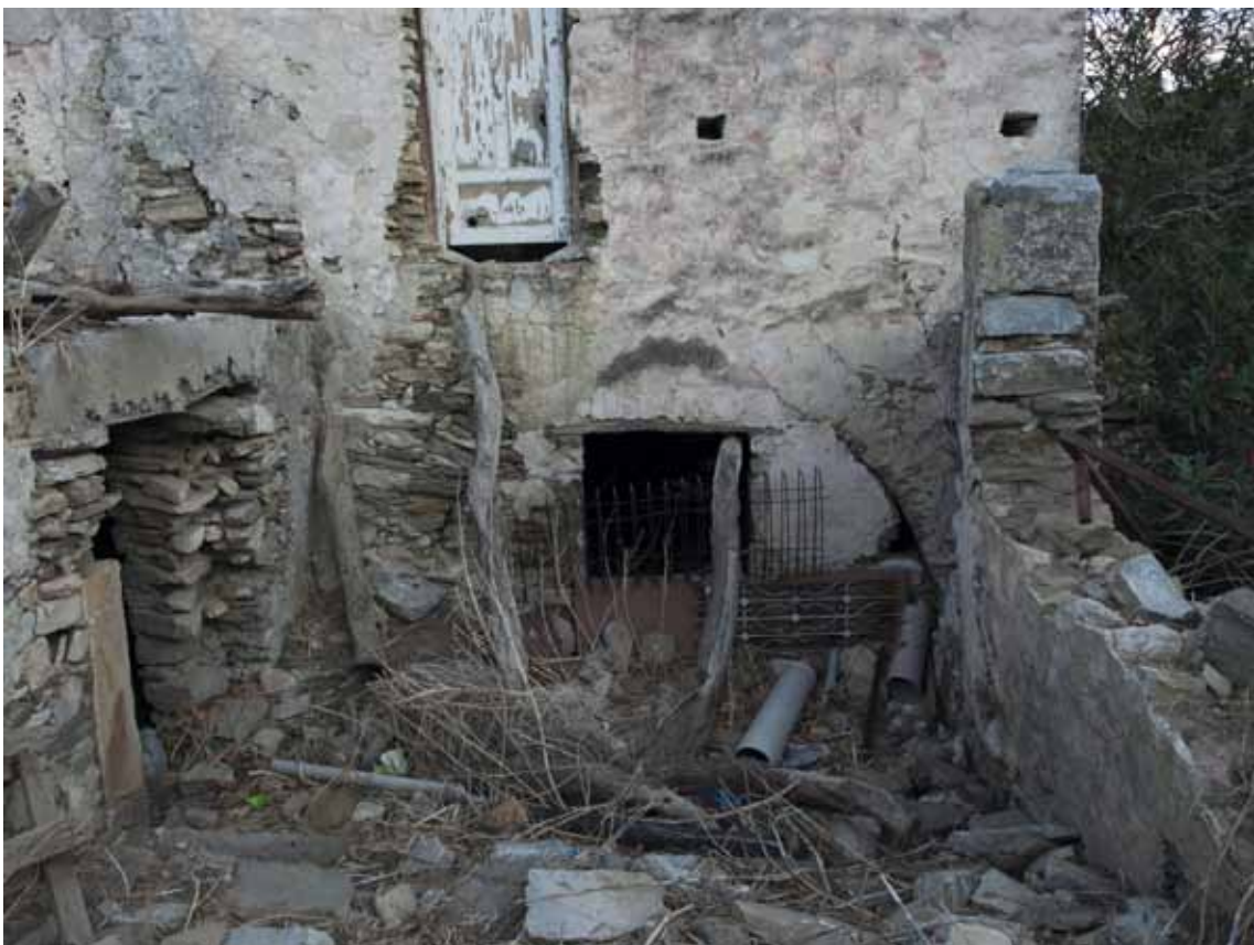
Φ.60. Η θύρα Θ_101 που οδηγεί στο ισόγειο μέσω της κεντρικής κλίμακας είναι μεταγενέστερη. Διακρίνεται ο αρμός στο οξυκόρυφο τόξο της μεγάλης αίθουσας (στοά)
