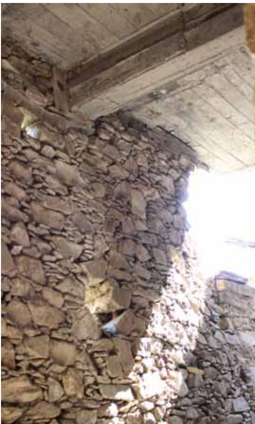
Φ.91. Ο ανατολικός τοίχος της έπαυλης όπου έχει παραμορφωθεί και τμήμα του έχει καταρρεύσει. Διακρίνεται η τοποθέτηση πλάκας και δοκαριού από οπλισμένο σκυρόδεμα
