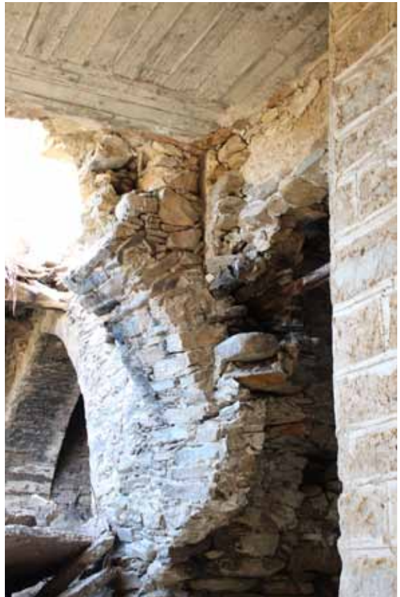
Φ.92. Η τοποθέτηση πλάκας και δοκαριού από οπλισμένο σκυρόδεμα ακύρωσε τη λειτουργία του τόξου με αποτέλεσμα την κατάρρευσή του
