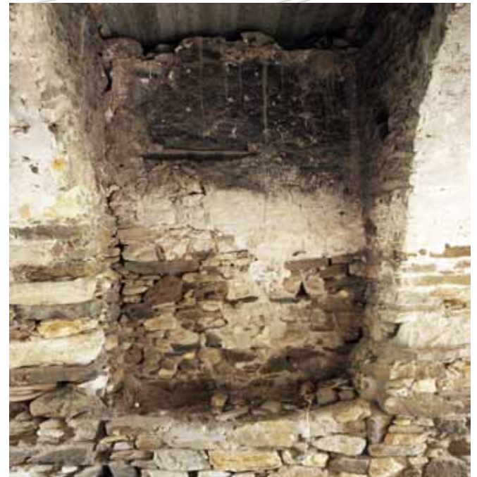
εικ. 39. Χώρος 101 του ισόγειου όπου διακρίνεται ο κατασκευαστικός αρμός της νοτιοδυτικής γωνίας της Γ φάσης
