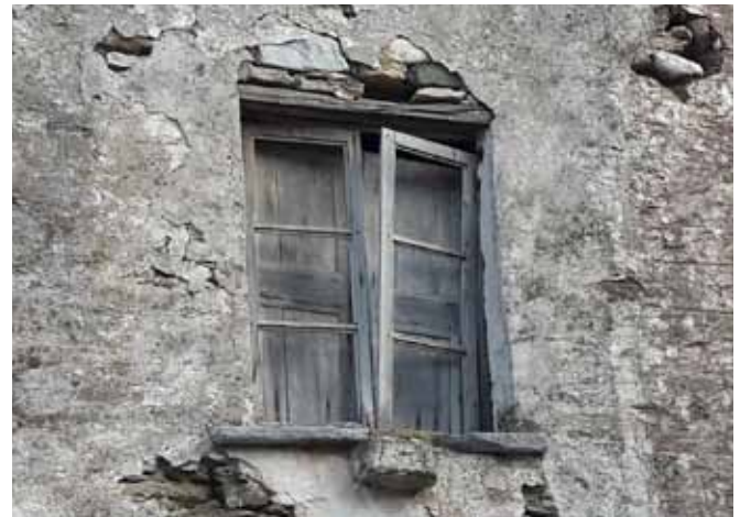
εικ. 56. Χαρακτηριστικό παράθυρο Π_206 σε κακή κατάσταση
