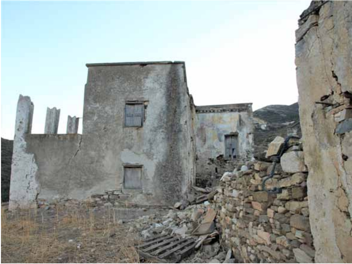
Φ.56. Βόρεια όψη της έπαυλης. Η υγρασία απο την “υδρορροή” έχει αλλιώσει την επιφάνεια του κτηρίου. Επίσης διακρίνεται η ρωγμή στην βεράντα πιθανών από καθίζηση και σίγουρα η μη ικανή συναρμογή των δύο φάσεων.
