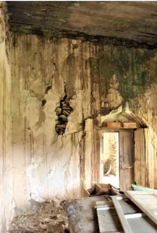
Φ.69. Η βόρεια τοιχοποιία του χώρου 203 του ορόφου έχει την μεγαλύτερη παραμόρφωση (μέχρι και το ισόγειο) από την εισροή των ομβριων υδάτων από την οροφή
