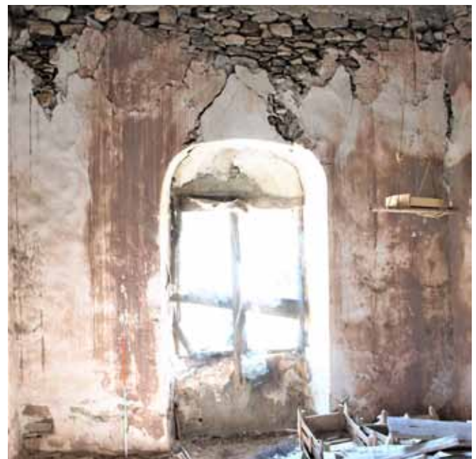
εικ. 54. Ρηγματώση και παραμόρφωση τοξωτού ανωφλιού του παραθύρου Π_202
