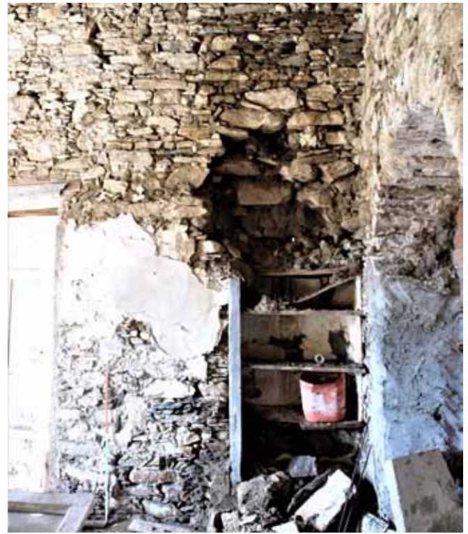
εικ. 47. Τοπική κατάρρευση άνω τμήματος εσωτερικού ερμαρίου (E_201)
