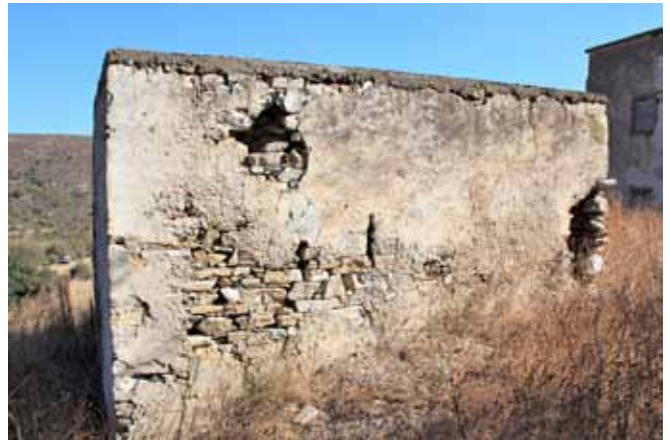
εικ. 66. Ο περιστεριώνας όπου έχουμε τοπικές καταρρεύσεις
