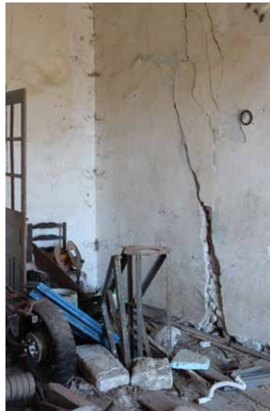
Φ.73. Η ρωγμή στον βόρειο τοίχο της σάλας βρίσκεται ακριβώς στην θέση όπου είναι η αλλαγή της φάσης
