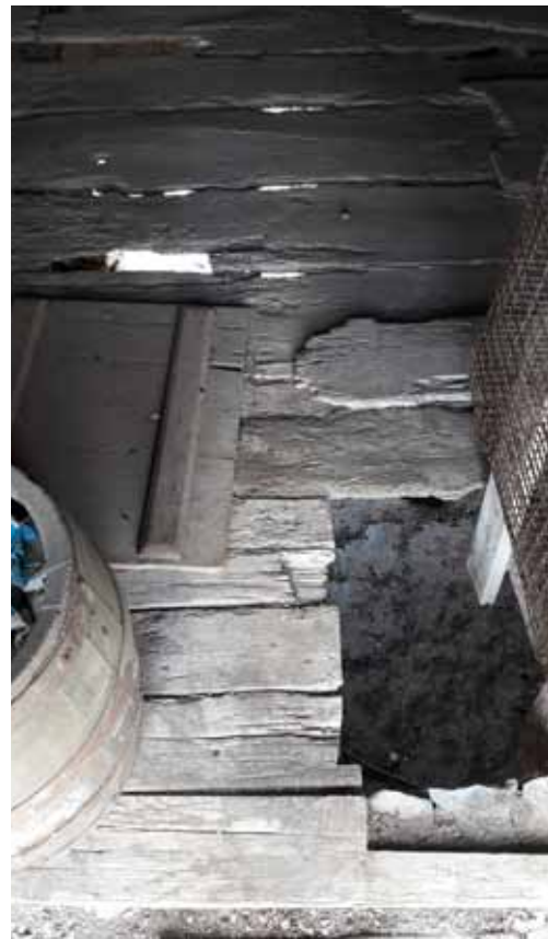
Φ.79. Το ξύλινο δάπεδο του χώρου 206 έχει διαβρωθεί και περιμετρικά έχει αποξηλωθεί για την τοποθέτηση των κλουβιών
