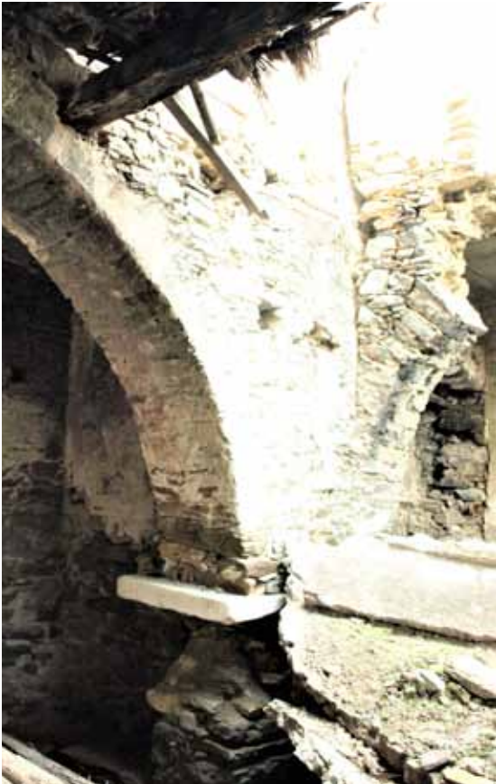
Φ.85. Δεξιά στην φωτογραφία παρατηρείται τμήμα του τόξου όπου έχει τώρα καταρρεύσει.
