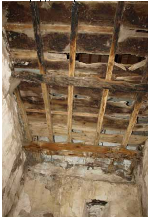
Φ.98. Στον χώρο 104 παρατηρείται το πάτωμα του ορόφου όπου είναι διαβρωμένο.
