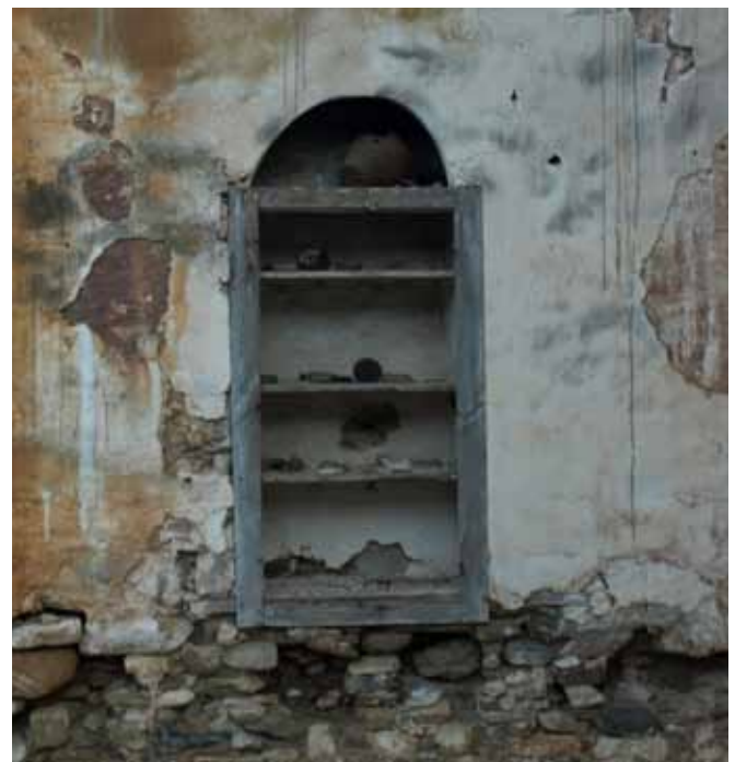
εικ. 25 Ράφι E_205 που βρίσκεται στην δυτική όψη μετά την κατάρρευση του μαγειριού
