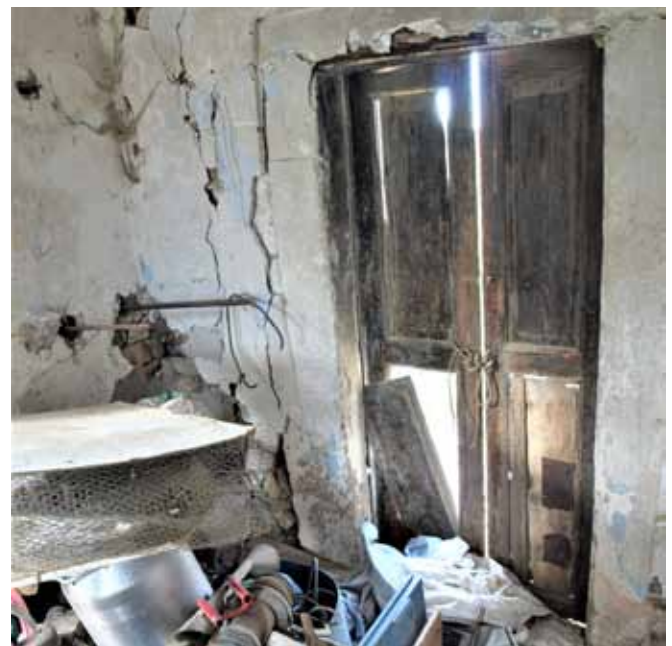
εικ. 57. Θύρα Θ_204 του ορόφου σε κακή κατάσταση
