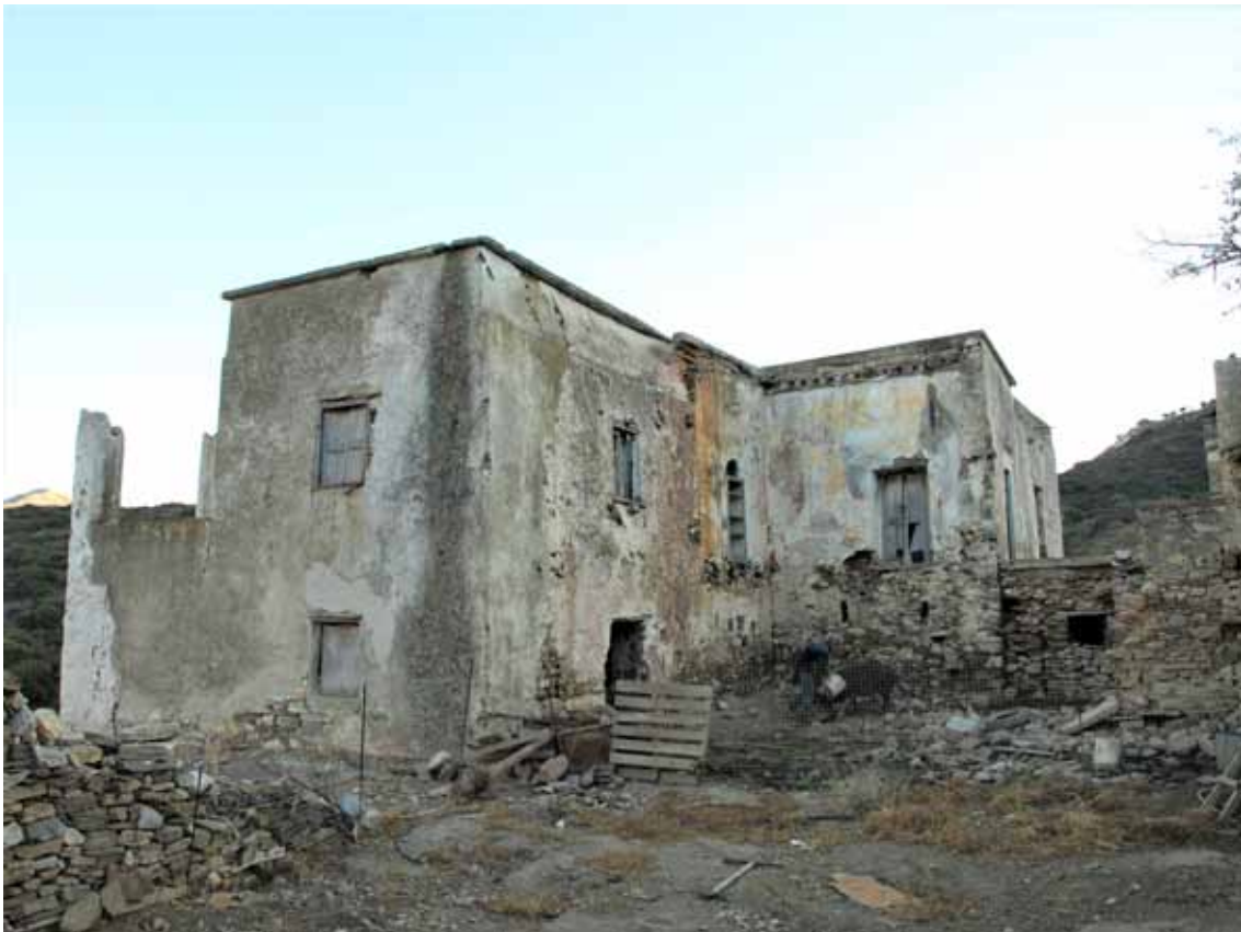
Φ.57. Βορειοδυτική άποψη της έπαυλης. Διακρίνεται η εσωτερική θύρα που μετά την κατάρρευση του μαγειρείου έχει εμφανιστεί στην όψη.
