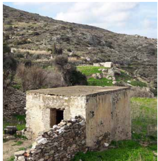
εικ. 34. Ο περιστεριώνας. Έχει αντικατασταθεί το δώμα με πλάκα από σπλισμένο σκυρόδεμα
