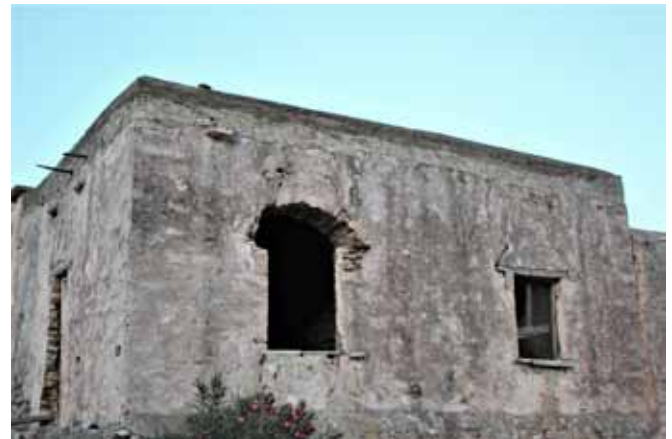
εικ. 53. Κατάρρευση τύμπανου ανακουφιστικού τόξου του παραθύρου Π_201 στη νότια όψη
