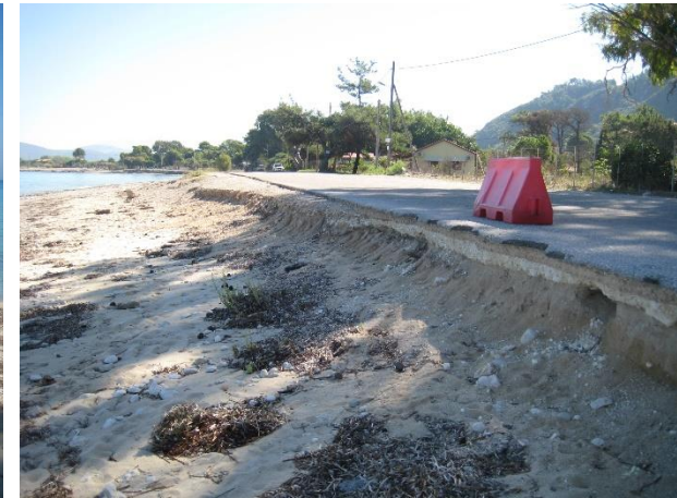
Εικόνα 4.3: Διάβρωση λόγω έντονης δράσης κυματισμών
