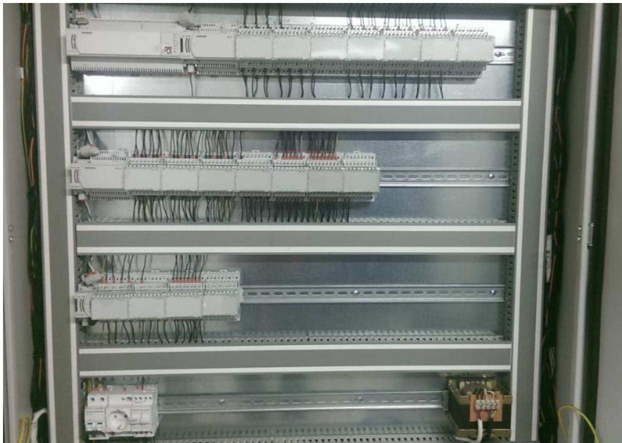
Σχήμα 3.33 Υπό Κατασκευή Πίνακας BMS εξεταζόμενου κτηρίου
