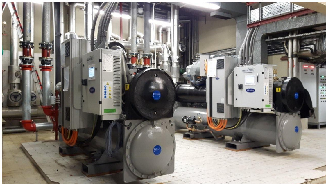
Σχήμα 42 Υδρόψυκτοι ψύκτες εξεταζόμενου κτηρίου
