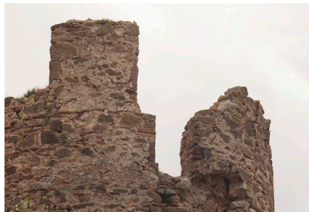
εικ.143_ άποψη της εισόδου στο δώμα στην βόρεια πλευρά του πύργου Π09
