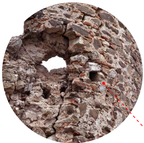
εικ.142_ ρωγμή στο ανώτατο τμήμα της τοιχοποιίας
