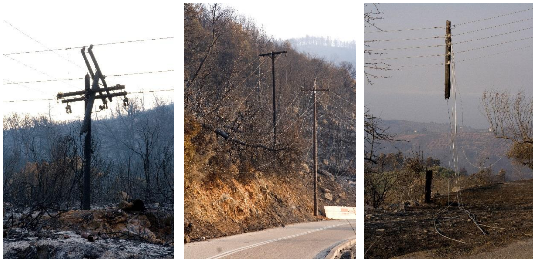
Εικόνα 1.2. Καταστροφές δικτύων διανομής που προκλήθηκαν στην Πελοπόννησο το 2007, λόγω πυρκαγιάς.
