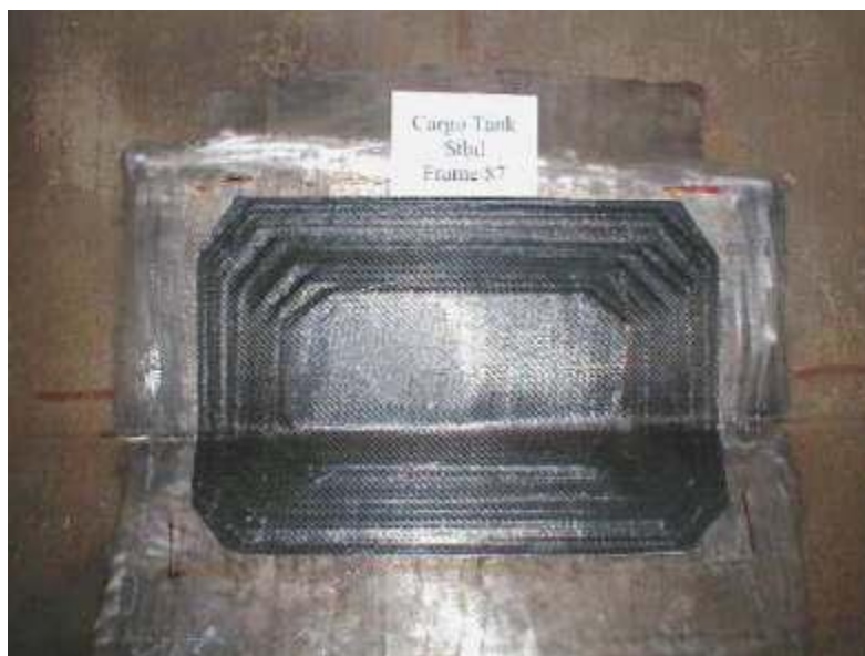
Σχήμα 1.9: Σύνθετο επίθεμα διαστάσεων 750×250 mm τοποθετημένο σε δεξαμενή φορτίου πλοίου FPSO για την επισκευή ρωγμής.
