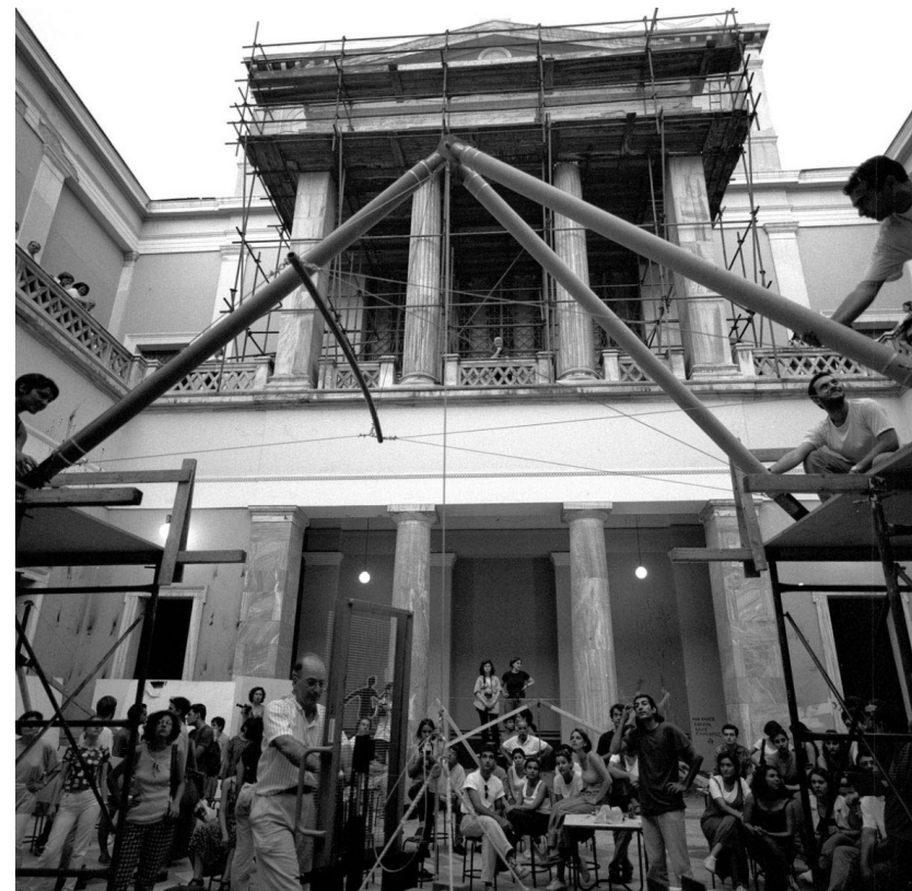
Εικόνα 60, Δημιουργία κατασκευών στο αίθριο για το μάθημα της οικοδομικής, © Αρχείο Οικοδομικής ΕΜΠ.
