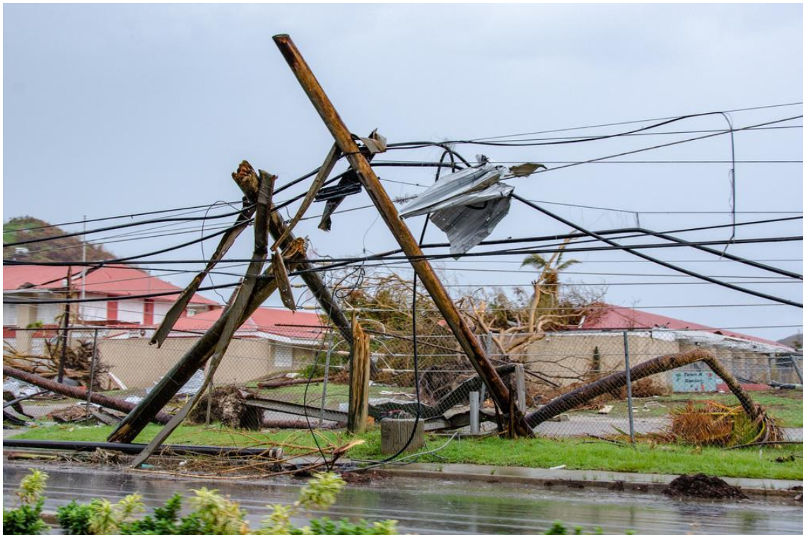
Εικόνα 2 Καταστροφή ηλεκτρικών πυλώνων και γραμμών εξαιτίας ακραίων καιρικών φαινομένων
