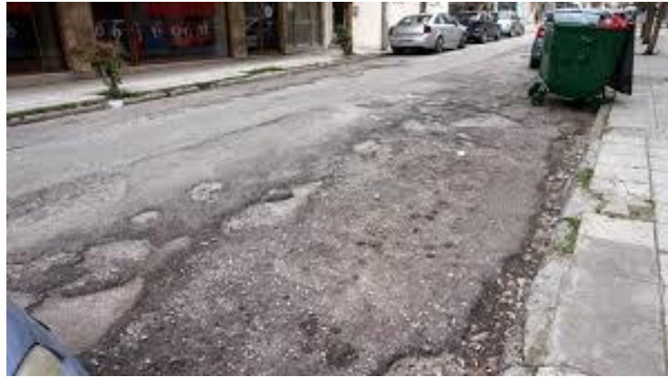
Εικόνα 2: Λειτουργική φθορά οδοστρώματος (Πηγή: www.patrasevents.gr )
