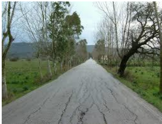
Εικόνα 5: Διαμήκεις ρωγμές (Πηγή: www.willhitweb.com )
