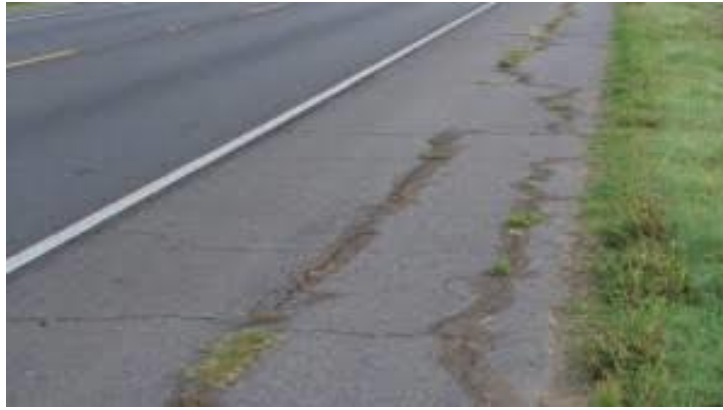
Εικόνα 10: Edge Cracks(Πηγή: www.mocktheorytest.com )
