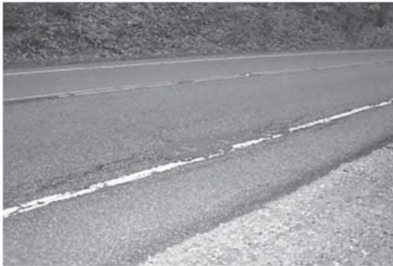
Εικόνα 15: Wheel track cracking (Πηγή: www.boulderlibrary.net )
