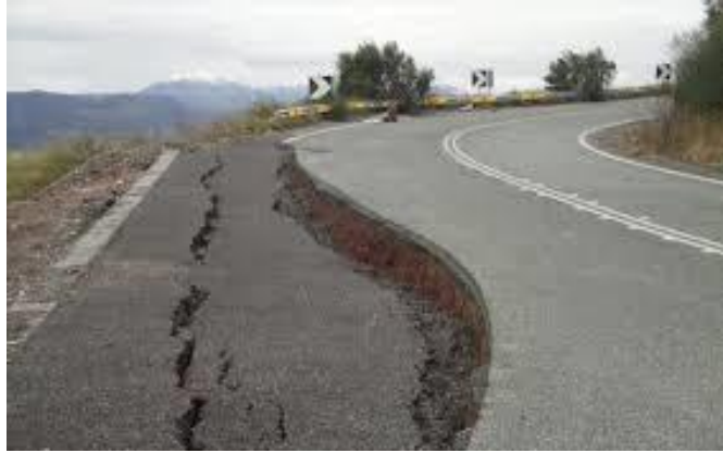
Εικόνα 7: Καθίζηση δρόμου (Πηγή: www.cnbc.com )
