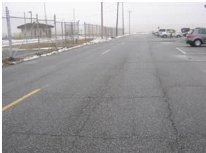
Εικόνα 12: Reflection cracks(Πηγή: www.civilblog.org )
