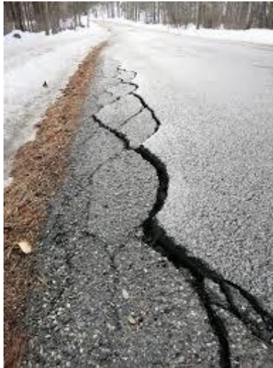
Εικόνα 17: Subsidence (Πηγή: www.nornow.org )
