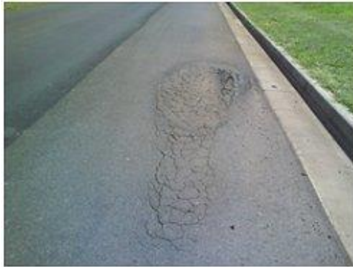
Εικόνα 13: Slippage cracks (Πηγή: www.onsitepaving.com )
