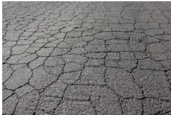
Εικόνα 9: Alligator cracks (Πηγή: www.coastalroadrepair.com )
