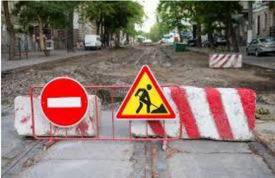
Εικόνα 1.1: Έργα επιδιορθωτικής συντήρησης αστικών οδοστρωμάτων
