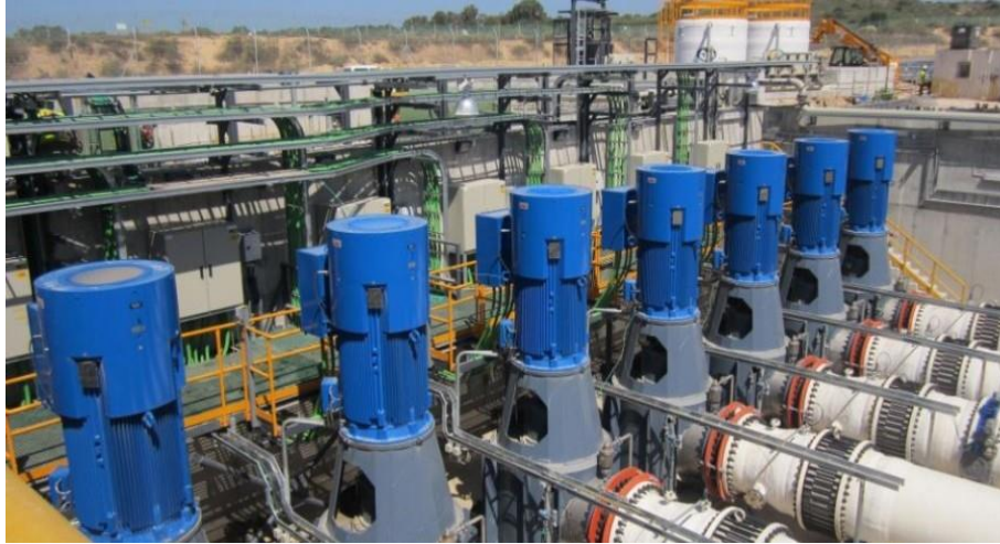
Σχήμα 1-5: Μονάδα Αφαλάτωσης στην Πάφο (Πηγή: http://www.sigmalive.com ).
