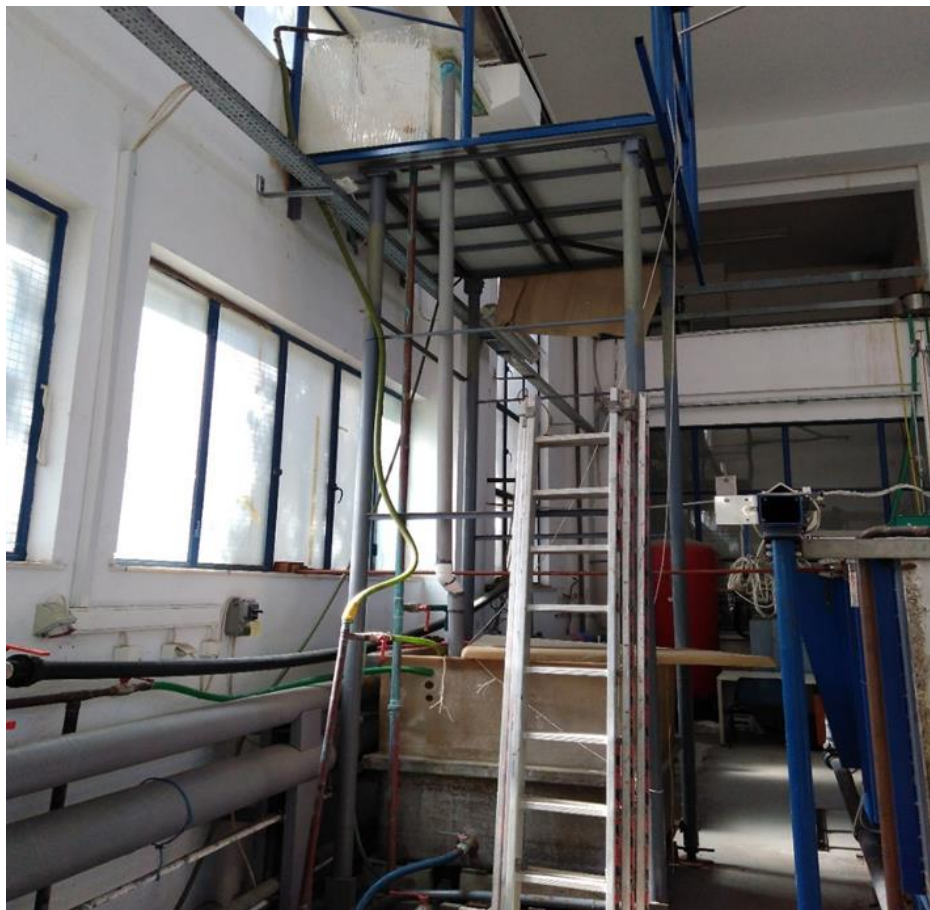
Σχήμα 4-5: Δεξαμενή Προετοιμασίας Διαλύματος (κάτω) και Δεξαμενή Τροφοδοσίας (επάνω)
