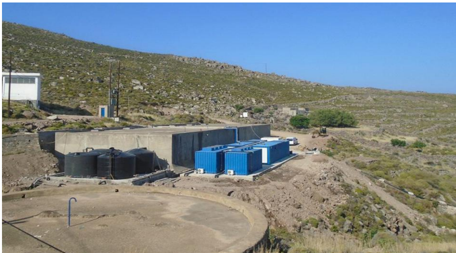
Σχήμα 1-6: Μονάδα Αφαλάτωσης στην Πάτμο (Πηγή: Εφημερίδα «Καθημερινή»).
