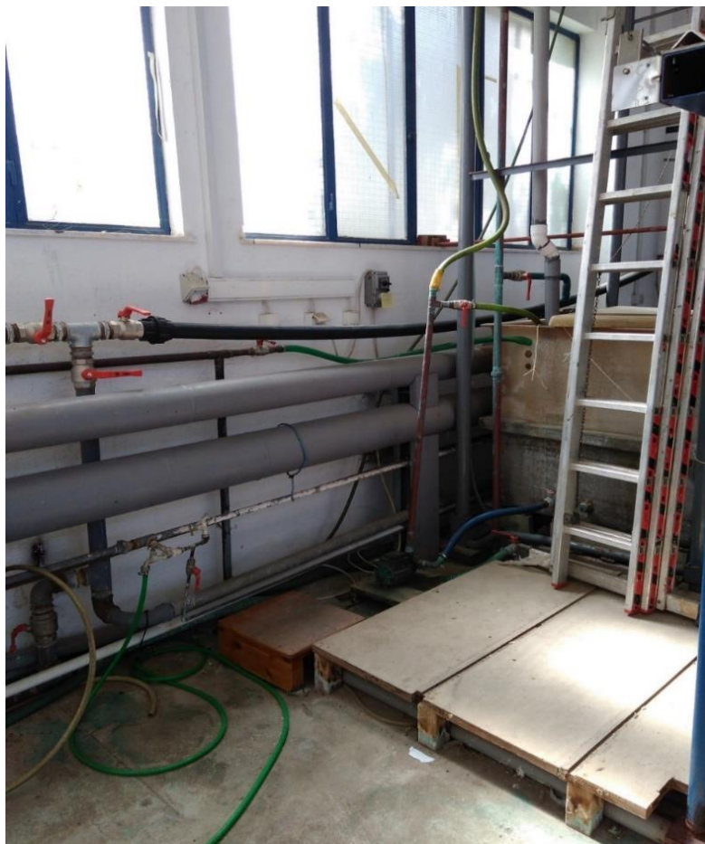
Σχήμα 4-4: Δεξαμενή Προετοιμασίας Διαλύματος, Αντλία ανακυκλοφορίας και Δικλείδες
