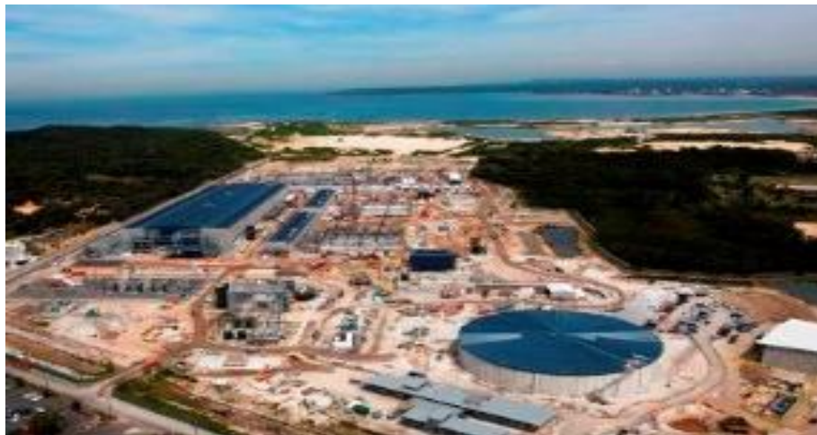
Σχήμα 1-3: Μονάδα Αφαλάτωσης στην Κύπρο (Πηγή: https://energypress.gr ).
