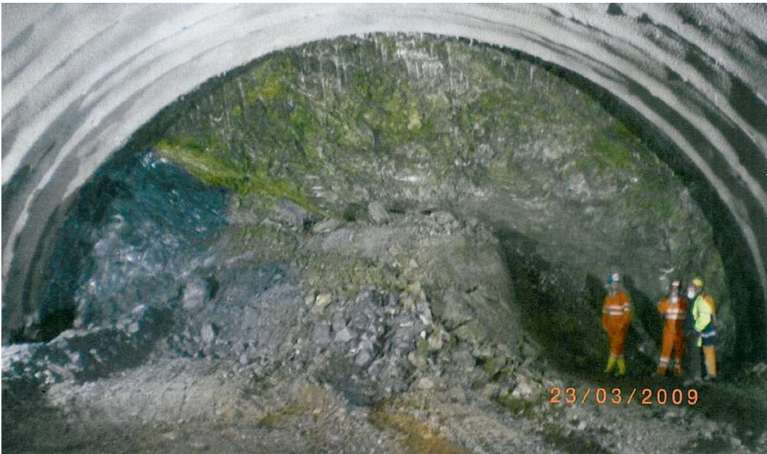
Εικόνα Παραρτήματος 17 Φυλλίτης με ενδιστρώσεις κρυσταλλικών ασβεστολίθων (k-ph) (Διατομή N074, SB, T1) Μέθοδος εκσκαφής:μηχανικά μέσα & εκρηκτικά, GSI=25~30, Βαθμός αποσάθρωσης:MW-CW, Υπερκείμενο ~34m, Χ.Θ. 3+661 (VINCI construction)
