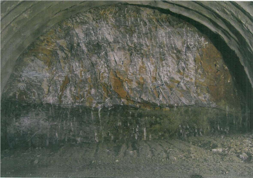
Εικόνα Παραρτήματος 30 Μεικτό μέτωπο φυλλίτη/κρυσταλλικού ασβεστολίθου (ρh/Kc) (Διατομή N308, SB, T2) Μέθοδος εκσκαφής: εκρηκτικά, GSI (ρh)=30~35 & GSI(kc)=50~60, Βαθμός αποσάθρωσης ρh: SW-MW & Βαθμός αποσάθρωσης kc: SW, Υπερκείμενο ~140m, Χ.Θ. 8+446 (MKC -JV)
