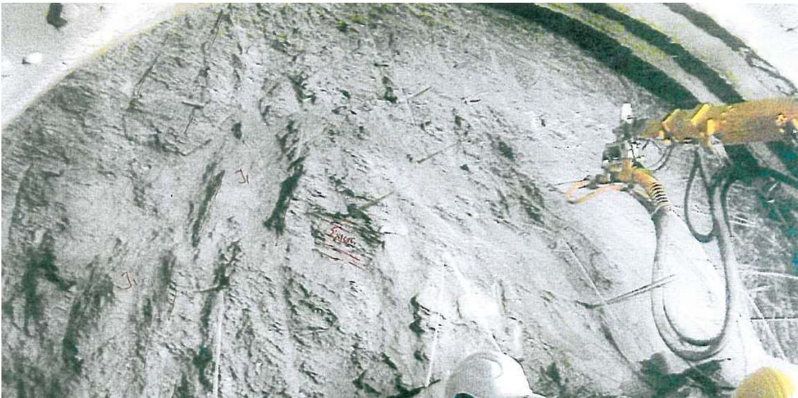
Εικόνα Παραρτήματος 23 Γραφικός ασβεστοφυλλίτης (ρh) (Διατομή N030, SB, T2) Μέθοδος εκσκαφής: μηχανικά μέσα, GSI=5~10, Βαθμός αποσάθρωσης: RS, Υπερκείμενο ~78m, Χ.Θ. 10+695 (MKC -JV)
