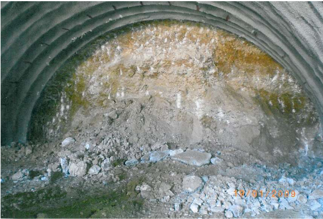
Εικόνα Παραρτήματος 16 Ασβεστολιθικό λατυποπαγές (ol-br) (Διατομή N019, SB, T1) Μέθοδος εκσκαφής:μηχανικά μέσα, GSI=25~30, Βαθμός αποσάθρωσης:MW-HW, Υπερκείμενο ~7m, Χ.Θ. 3+761 (VINCI construction)
