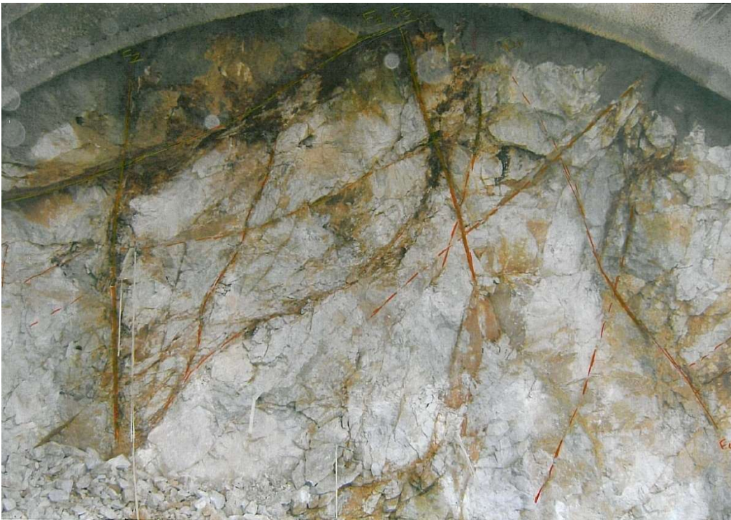
Εικόνα Παραρτήματος 32 Κρυσταλλικός ασβεστόλιθος (κρ) (Διατομή N001, NB, T3) Μέθοδος εκσκαφής: εκρηκτικά, GSI=35~45, Βαθμός αποσάθρωσης: HW, Υπερκείμενο ~10m, Χ.Θ. 14+326 (MKC -JV)
