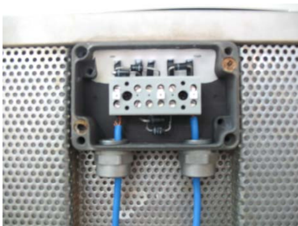
Εικόνα 21 : Παρακαμπτήριες διόδους φωτοβολταϊκού πλαισίου
