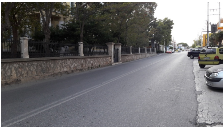
Εικόνα 28: Τμήμα της Αθηνών-Σουνίου χωρίς πεζοδρόμιο
