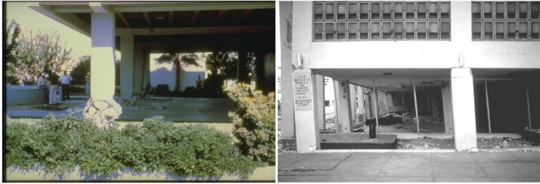
Εικόνα 1-2: Αστοχία στη βάση υποστυλωμάτων πιλοτής ισογείου
