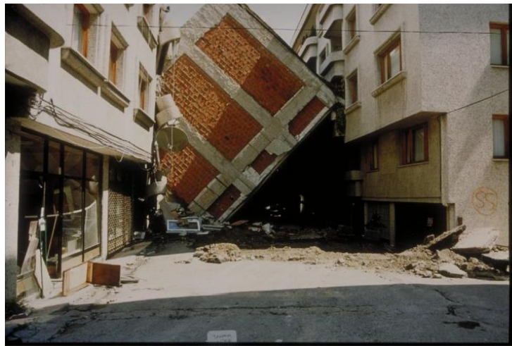
Εικόνα 1-3: Κατάρρευση κτιρίου μετά από σχηματισμό μηχανισμού πλαστικού ορόφου
