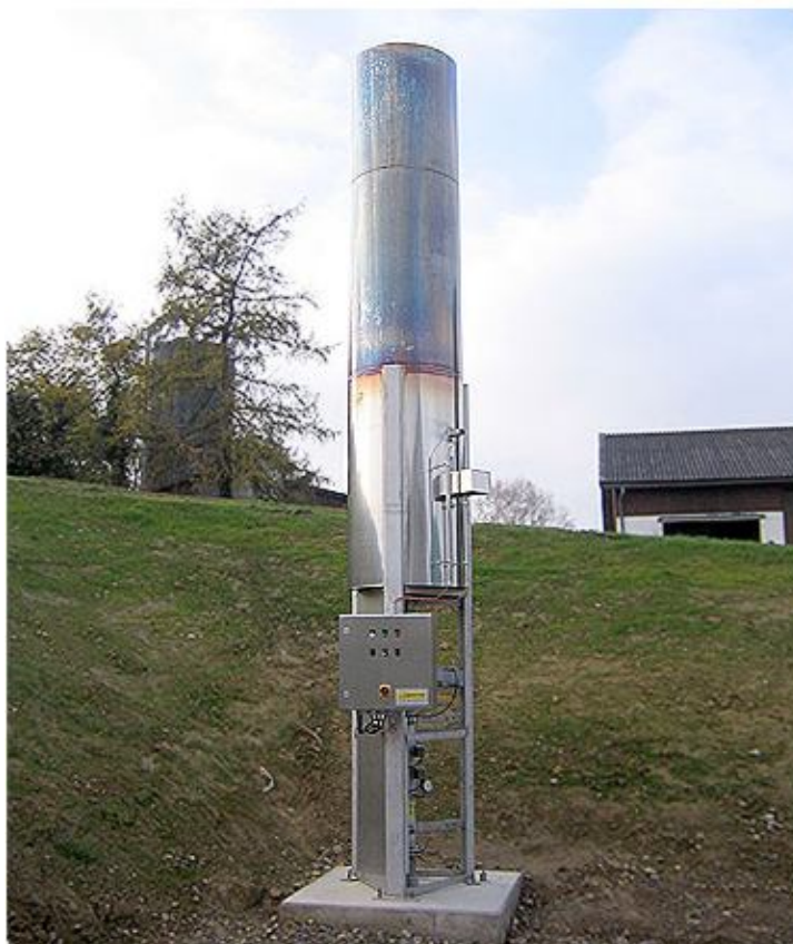
Σχήμα 4.4.: Πυρσός Καύσης Περίσσειας Βιοαερίου [25]
