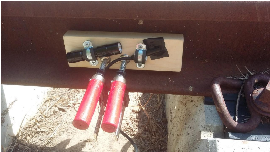
Εικόνα 3.2: Τοποθετημένη μικροκάμερα επί της σιδηροτροχιάς
