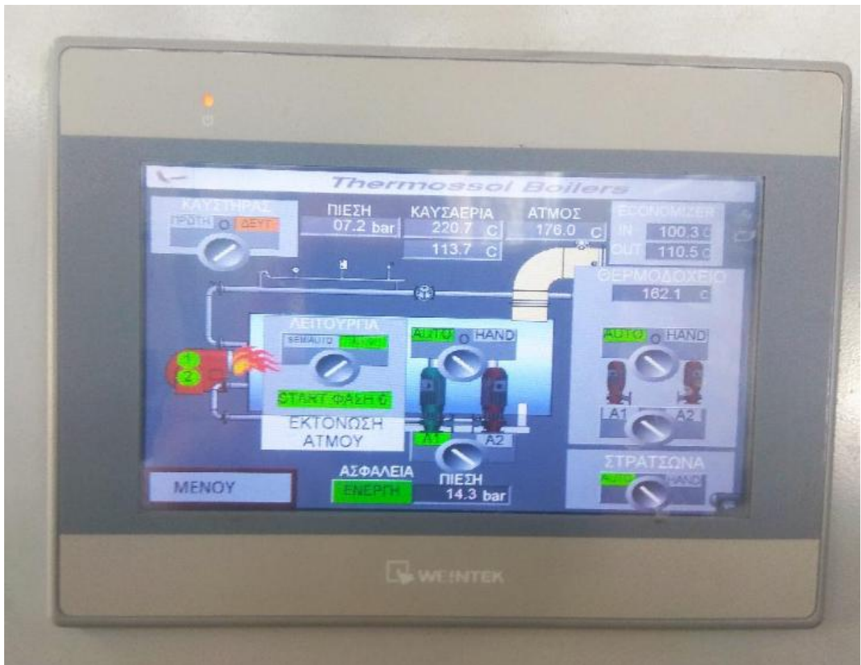
Εικόνα 5.8: Πρώτη καταγραφή θερμοκρασιών σε συνθήκες λειτουργίας της εγκατάστασης [29]
