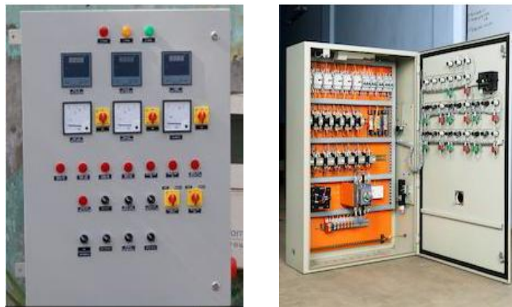
Εικόνα 2.5: Ηλεκτρικός Πίνακας Ελέγχου [14]
