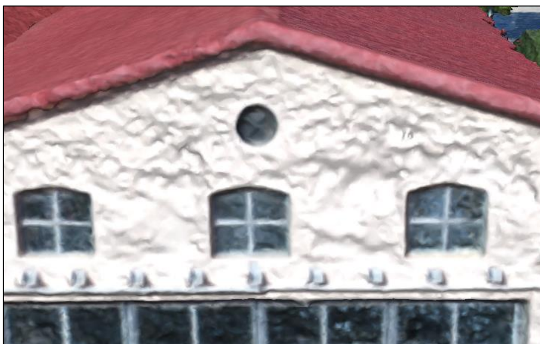
Εικόνα 3.20: Παραμορφώσεις επιφάνειας κακής πύκνωσης
