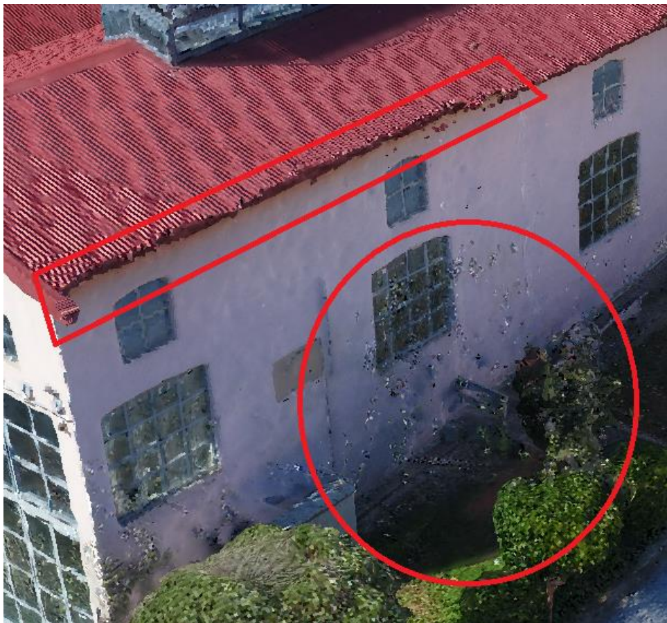
Εικόνα 3.33: Παραμορφώσεις σε στέγη και περιβάλλον
