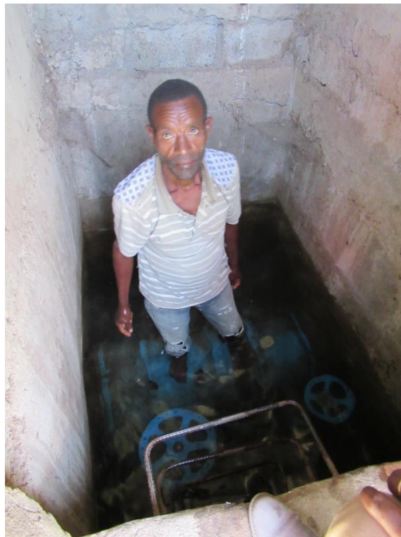
Εικόνα 4.5 Έξοδος αγωγού υδροληψίας - βαλβίδες ρύθμισης ροής βυθισμένες στο νερό
