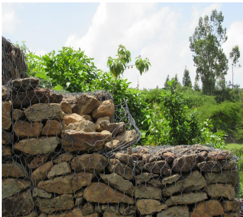
Εικόνα 4.4 Παραμόρφωση συρματοκιβωτίου του υπερχειλιστή
