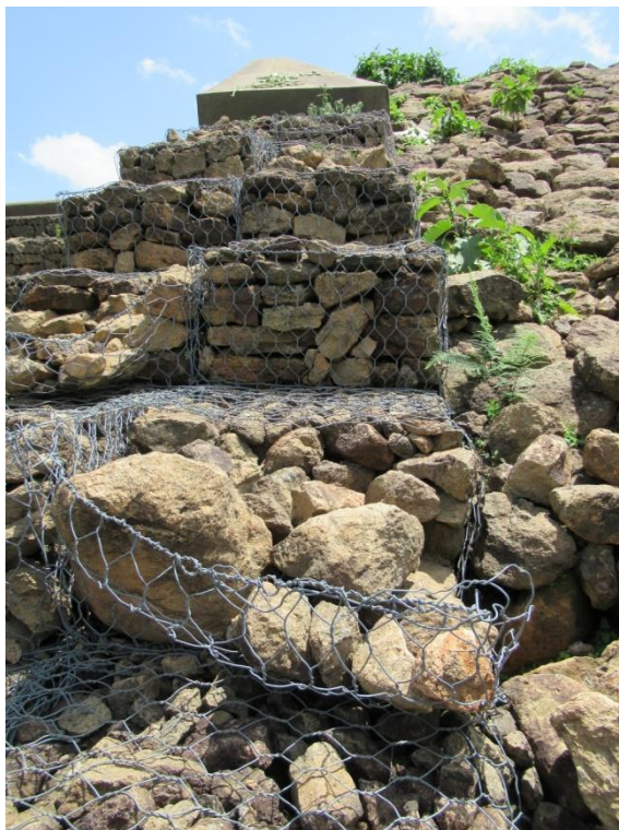
Εικόνα 4.3 Φθορές στα gabions του υπερχειλιστή
