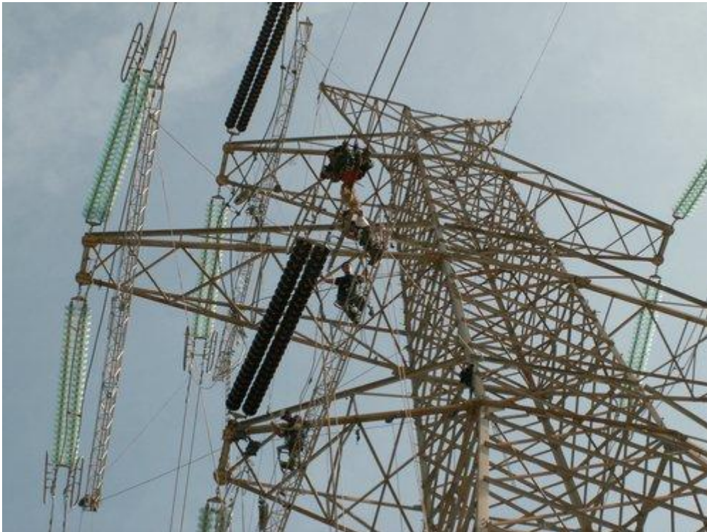
Εικόνα 2.1.1 Πυλώνας Υψηλής Τάσης Ηλ.Ρεύματος
