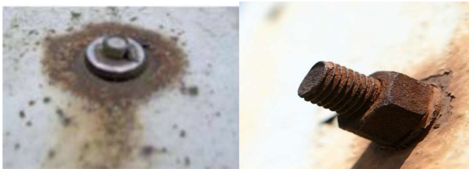
Εικόνα 1.5: Προβλήματα σε συνδέσεις με κοχλίες Figure 1.5: Problems with rusted bolts
