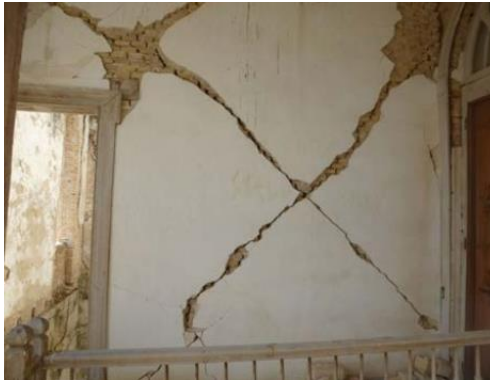
Εικόνα 2.18 Αστοχία λόγω εντός επιπέδου τέμνουσας-χιαστί ρωγή.
