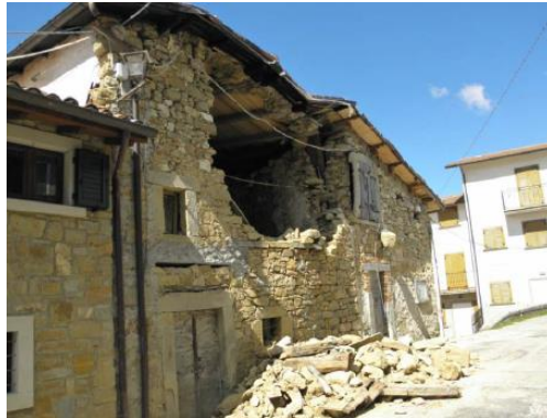
Εικόνα 2.19 Αστοχία λόγω εκτός επιπέδου κάμψης, εξαιτίας κακής σύνδεση τοιχοποιίας με στέγη.
