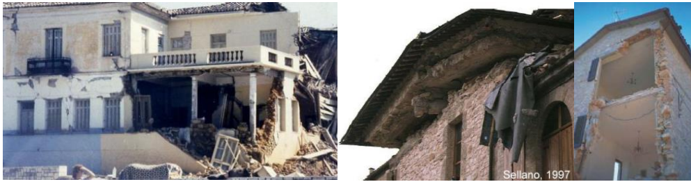
Εικόνα 7.15 Κατασκευές ενισχυμένες μέσω δημιουργίας διαφράγματος πλάκας οπλισμένου σκυροδέματος, όπου οι τοιχοποιίες κατέρρευσαν κατά τη σεισμική καταπόνηση.
