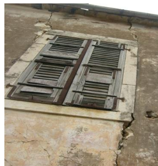
Εικόνα 3.45 Κατακόρυφες ρωγμές λόγω εντός επιπέδου κάμψης στην ανατολική όψη.
