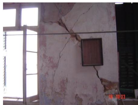
Εικόνα 3.47 Χιαστί ρωγμή λόγω εντός επιπέδου διάτμησης στον πεσσό της προσθήκης.
