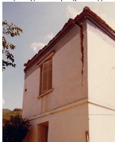
Εικόνα 2.21 Αστοχία λόγω εκτός επιπέδου κάμψης εξαιτίας κακής σύνδεσης των τοίχων.
