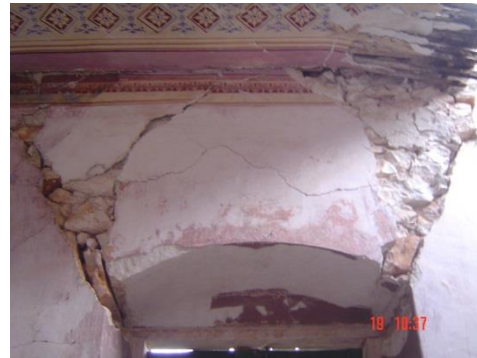
Εικόνα 3.14 Ρωγμές κάμψης και δομή τοιχοποιίας στην καμάρα του ανοίγματος της προσθήκης.
