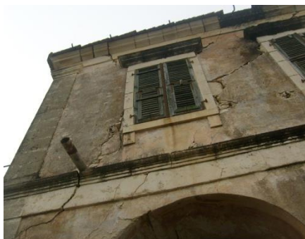
Εικόνα 3.43 Ρωγμές λόγω τέμνουσας και κάμψης εκτός επιπέδου στο τμήμα της προσθήκης.
