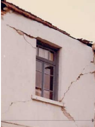
Εικόνα 2.16 Αστοχία λόγω εντός επιπέδου κάμψης-οριζόντια ρωγή πάνω αριστερά στο άνοιγμα.
