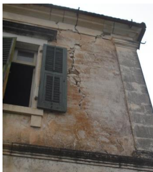
Εικόνα 3.44 Κατακόρυφη ρωγμή λόγω εκτός επιπέδου κάμψης στη βόρεια όψη.
