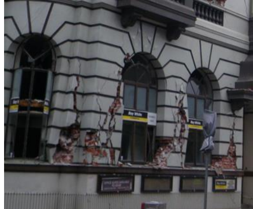
Εικόνα 2.17 Αστοχία στη βάση του τοίχου λόγω θλίψης. Λειτουργία τοίχου-διατμητικού προβόλου.
