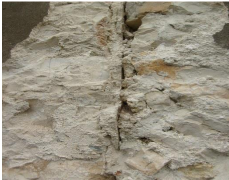
Εικόνα 3.13 Κατακόρυφος αρμός προσθήκης και αρχικού κτιρίου.
