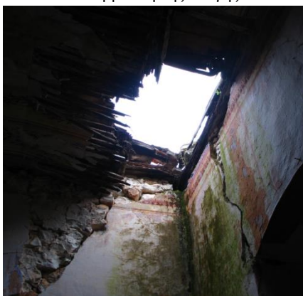
Εικόνα 3.48 Τμηματική κατάρρευση της στέγης στο τμήμα της προσθήκης. Φαίνεται η ανεπαρκής σύνδεση της στέγης με τον τοίχο.
