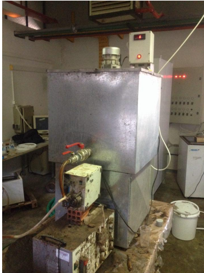
Εικόνα 5.1.2 Ψυγείο και περισταλτική αντλία τροφοδοσίας
