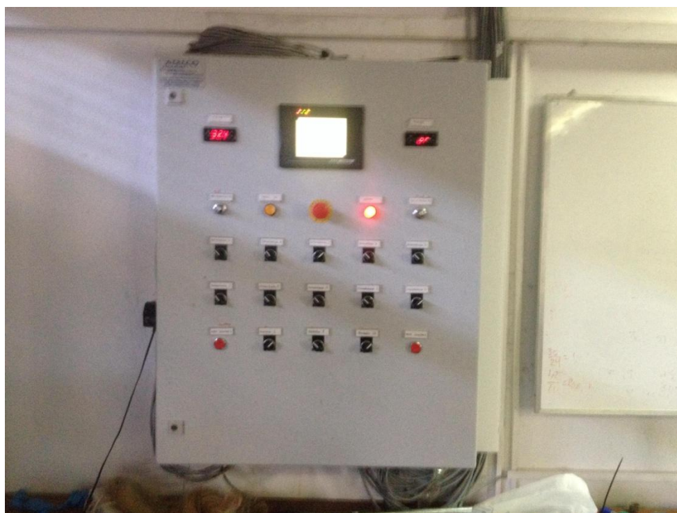
Εικόνα 5.1.3 Πίνακας ελέγχου PLC
