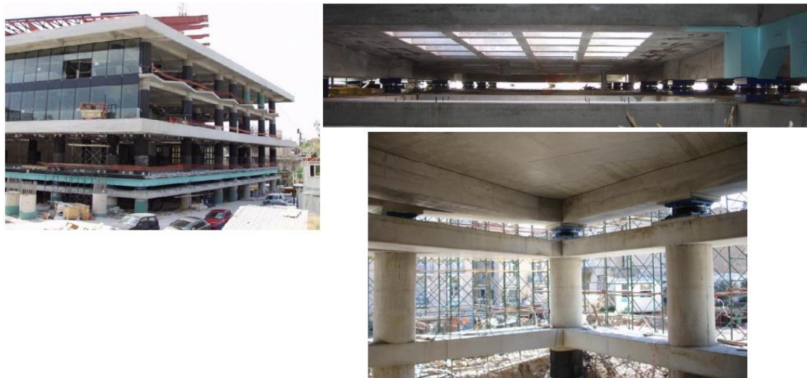
Σχήμα 1.9: Η εφαρμογή της σεισμική μόνωσης στο νέο μουσείο Ακρόπολης κατά τη φάση κατασκευής.
