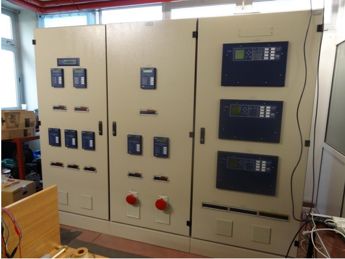
Εικόνα 3α. Υποσυστήματα Διανομής και Προστασίας Εξομοιωτή
