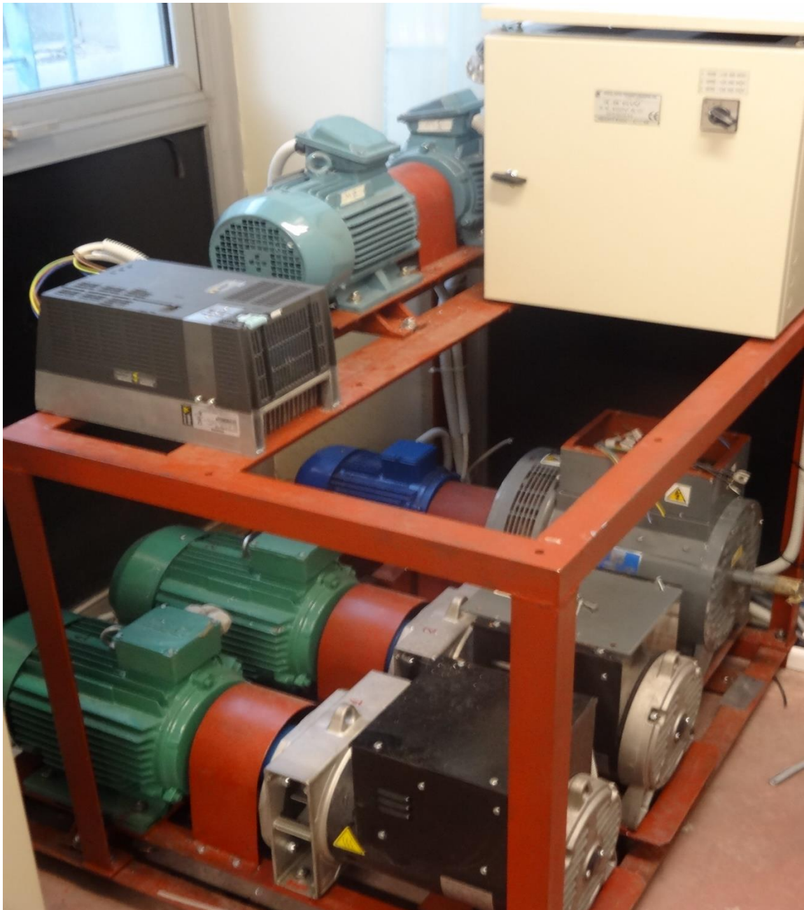
Εικόνα 1α. Ηλεκτρικές Μηχανές του Εξομοιωτή Ηλεκτρικού Δικτύου Πλοίου
