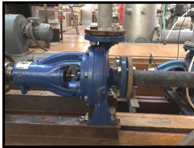
Σχήμα 3 : Εγκατάσταση της φυγοκεντρικής αντλίας νερού LDP 32-160 που εξετάζεται.
