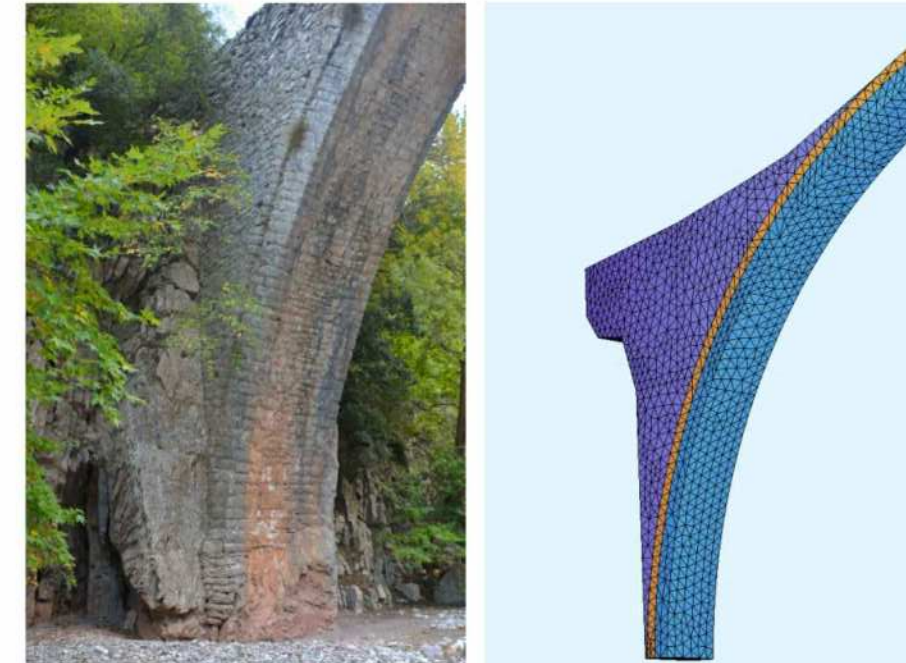
Εικόνα 6.5 Έδραση γέφυρας Τριζώλου, (Φωτογραφία Χρήστος Γιαννέλος) σε αντιστοίχιση με τμήμα του προσομοιώματος της Γέφυρας Κοράκου
