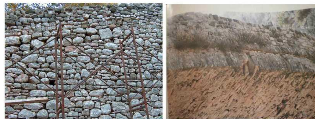
Εικόνα 4.19 Λιθοδομή δεξιού βάθρου και δόμησης τόξου πριν την αποκατάσταση, Μ.Καραβεζύρογλου Δρ. Πολιτικός Μηχανικός, Καθηγήτρια, Αριστοτέλειο Πανεπιστήμιο Θεσσαλονίκης Ε. Καραγιάννη Πολιτικός Μηχανικός, Διεύθυνση Τεχνικών Υπηρεσιών Ν.Α.Τρικάλω
