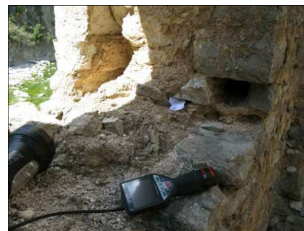
ΦΩΤΟΓΡΑΦΙΑ 7 ΟΠΕΣ ΞΥΛΟΔΕΣΙΩΝ – ΕΞΟΠΛΙΣΜΟΣ ΕΝΔΟΣΚΟΠΗΣΗΣ
