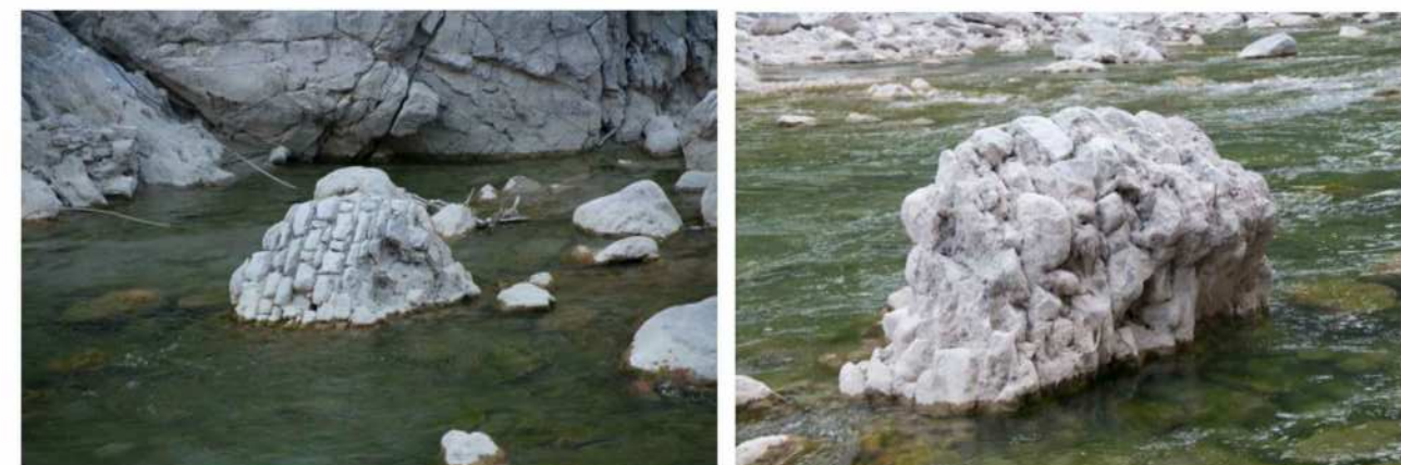
Εικόνα 3.21 Τμήμα της γέφυρας εντός της κοίτης , διάβρωση λίθων, λήψεις 2017
