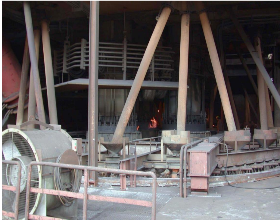
Εικόνα 12: Ηλεκτρικές κάμνοι του εργοστασίου ΛΑΡΚΟ
