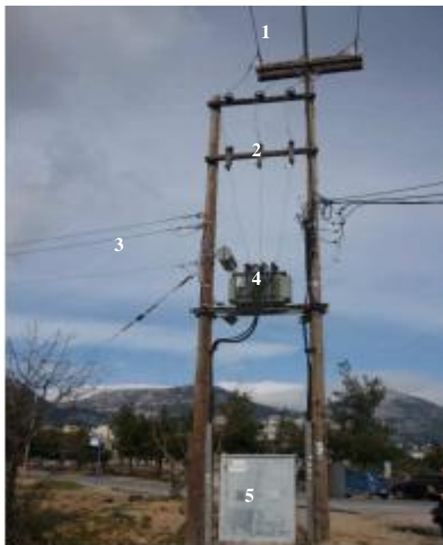
Σχήμα 4.2.1: Τυπικός δίστυλος υποσταθμός διανομής. 1. Γραμμή Μέσης τάσης, 2. Ασφαλειοαποζεύκτες, 3.Γραμμή Χαμηλής τάσης, 4. Μετασχηματιστής, 5.Ασφαλειοκιβώτιο Χαμηλής τάσης.
