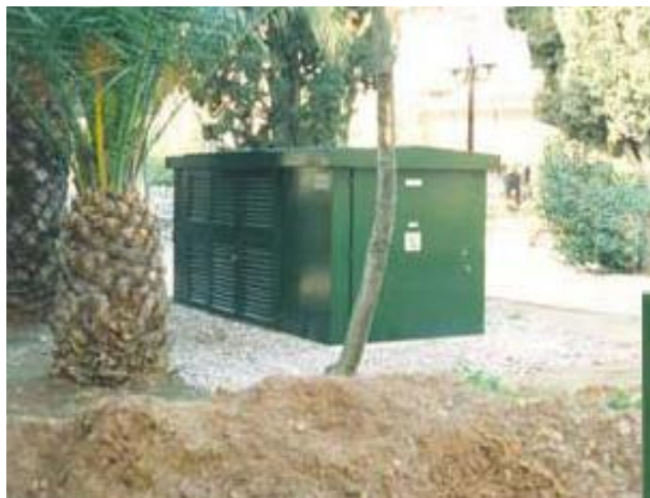
Σχήμα 4.4.1: Υποσταθμός διανομής εντός μεταλλικού οικίσκου (κίосκ).
