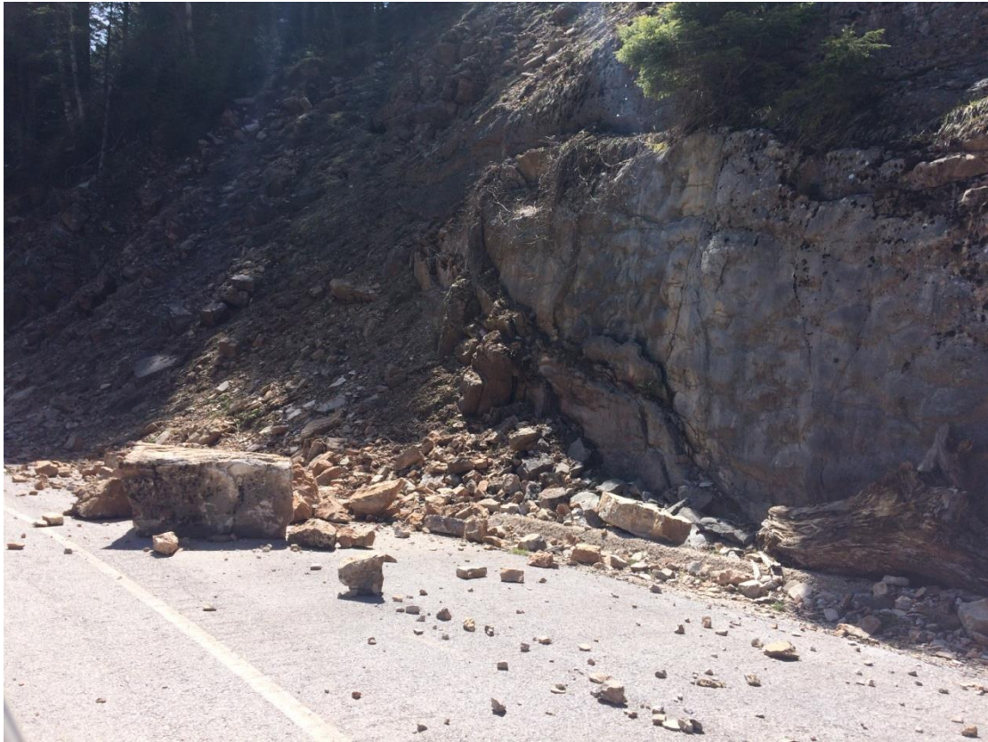
Εικόνα 18: Καταστροφές οδικού δικτύου, (προσωπικό αρχείο)
