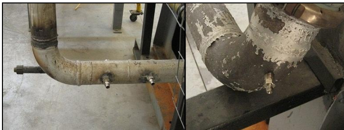
Εικόνα 2.18 Το σύστημα εξαγωγής καυσαερίων του κινητήρα diesel Mercedes-Benz OM 366 LA, όπου διακρίνονται οι οπές προσαρμογής του θερμοστοιχείου και των σωληνώσεων αναρρόφησης των αναλυτών καυσαερίων.
