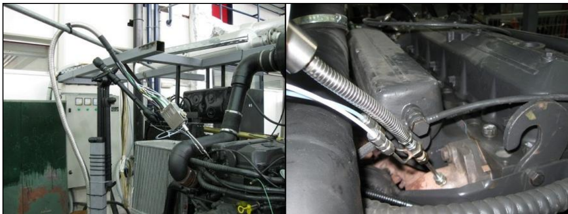
Εικόνα 3.16 Εγκατάσταση της πρώτης κεφαλής δειγματοληψίας του αναλυτή CLD 500 μετά τη βαλβίδα εξαγωγής του πρώτου κυλίνδρου, γενική φωτογραφική άποψη (αριστερά) και λεπτομέρεια της εφαρμογής στην πολλαπλή εξαγωγής του κινητήρα (δεξιά).
