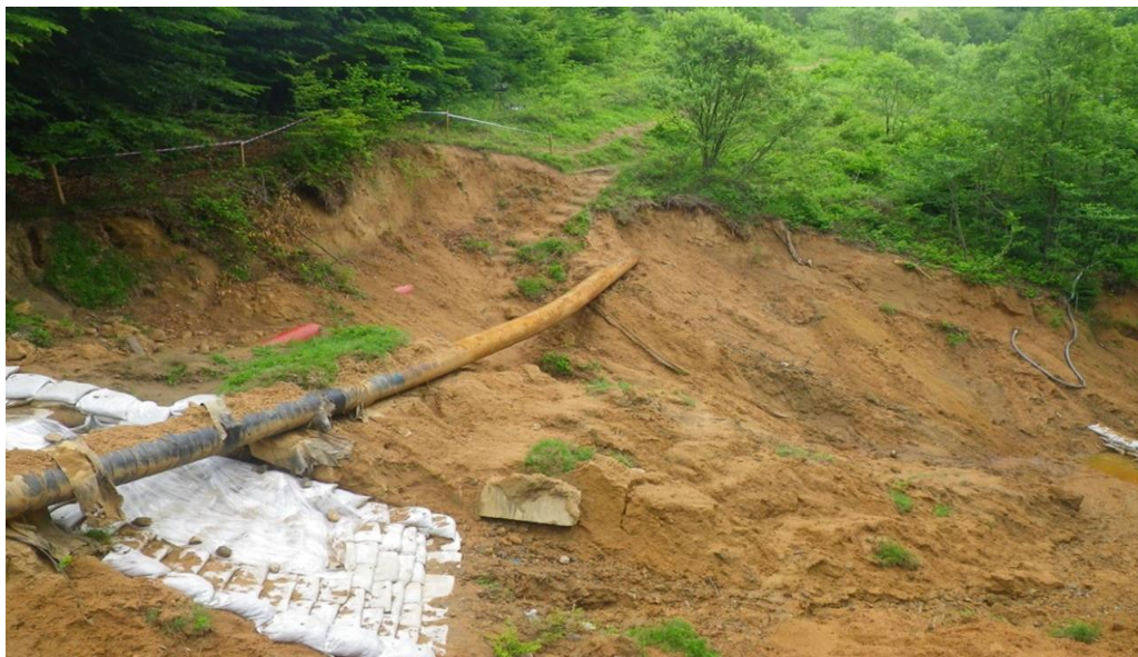
Εικόνα 3.12: Θέματα κατολίσθησης αγωγού σε ορεινά εδάφη. (Πηγή: http://qjegh.lyellcollection.org )
