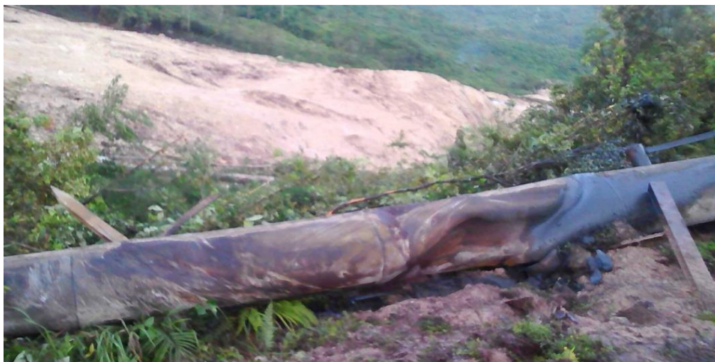
Εικόνα 3.13: Καταστροφή του αγωγού από χαλκό Ok Tedi από καταλίσθηση λόγω σεισμού (Πηγή: www.medium.com )
