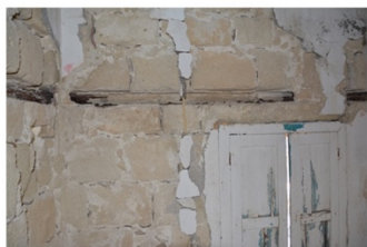
Ανεξέλεγκτη είσοδος νερού: Διάβρωση και σήψη ξύλινων στοιχείων και ξυλοδεσιών
