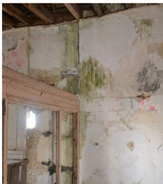
Υγρασία: Αποσάθρωση, ρωγμές και πτώση επιχρισμάτων στο εσωτερικό
