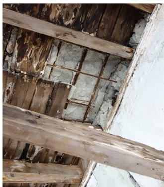
Προσθήκη οπλισμένου σκυροδέματος στο δώμα: Επιβάρυνση της στέγασης σταδιακή κατάρρευση
