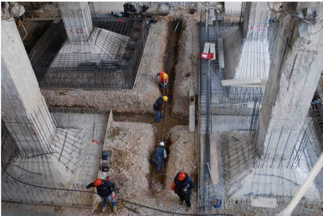
(εικόνα 2: ενίσχυση πεδίων)
