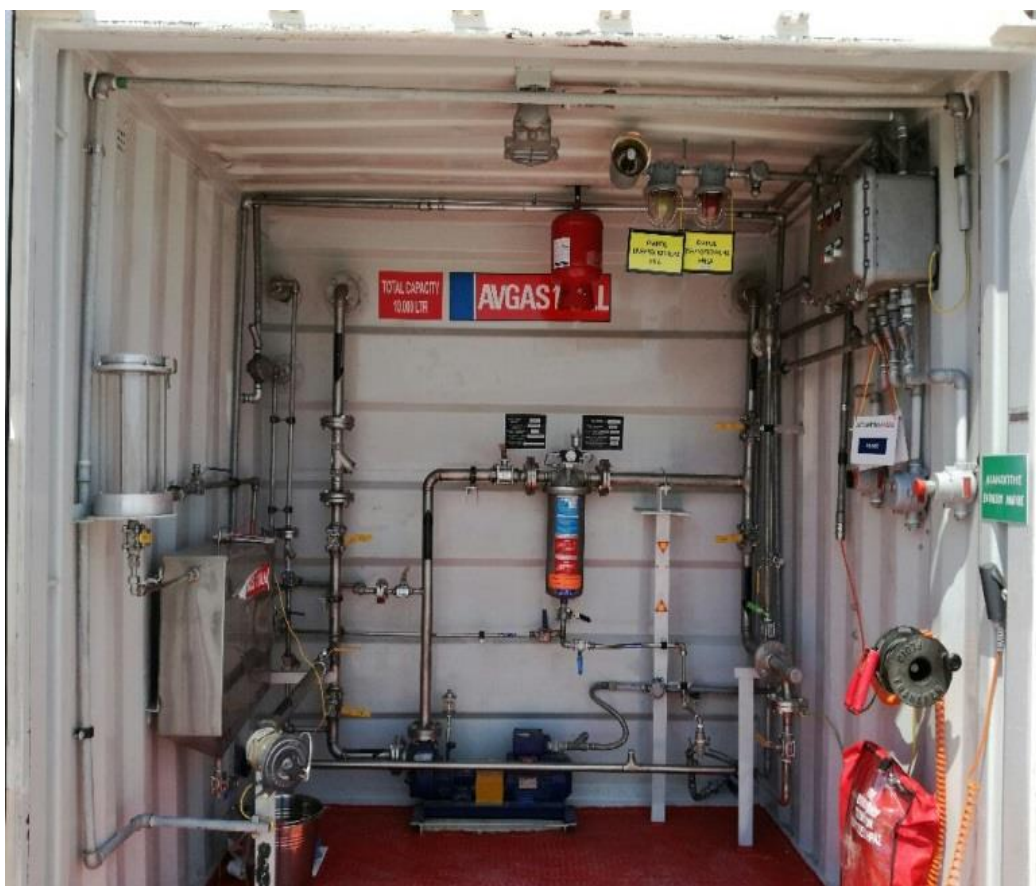
Εικόνα 4.4: Ο εξοπλισμός του container AvGas
