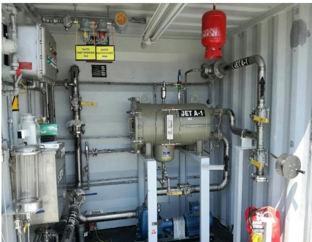
Εικόνα 4.2: Ο εξοπλισμός του container Jet A-1
