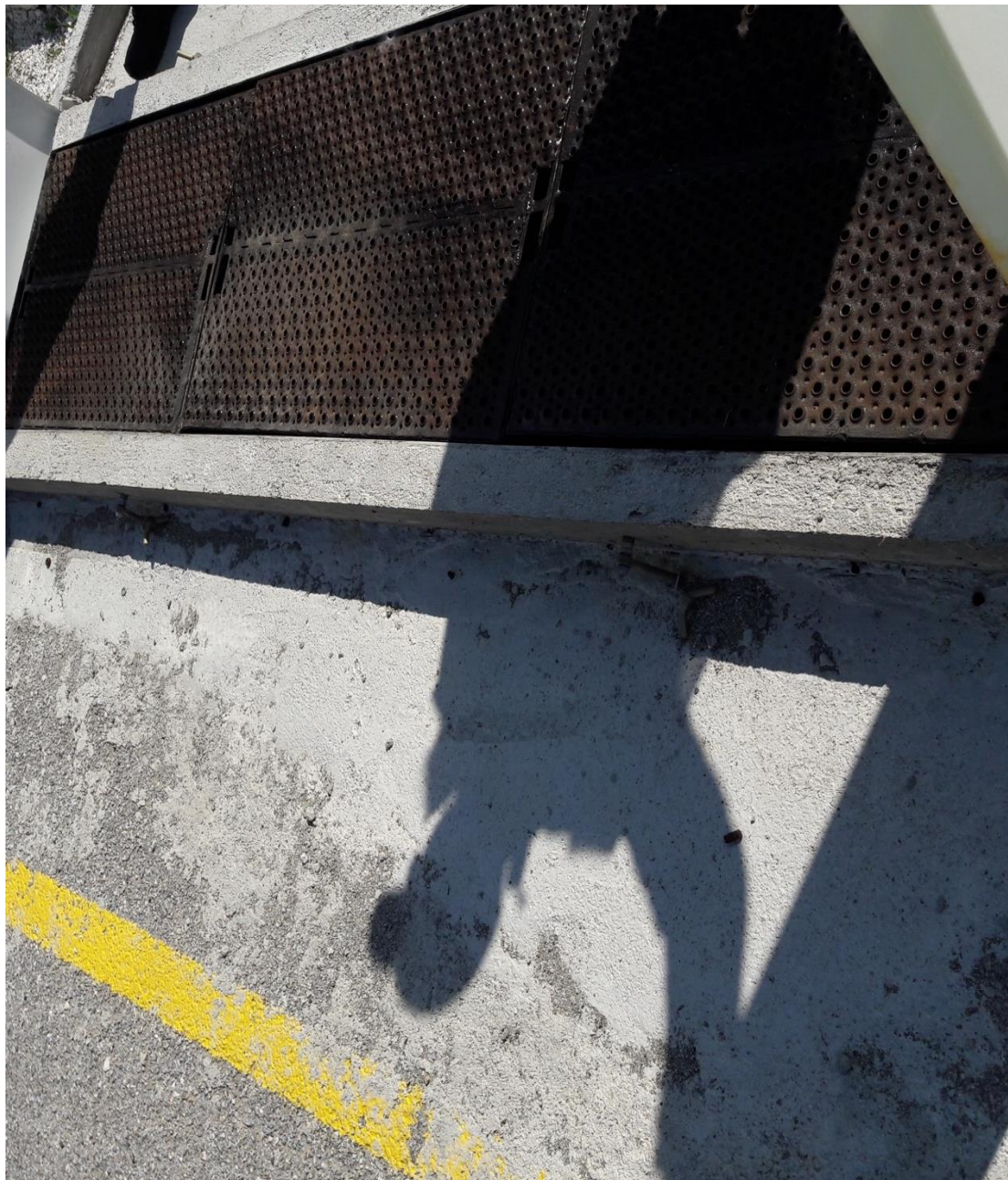
Εικόνα 4.9: φρεάτιο για αναρρόφηση του καυσίμου από τη δεξαμενή όμβριων
