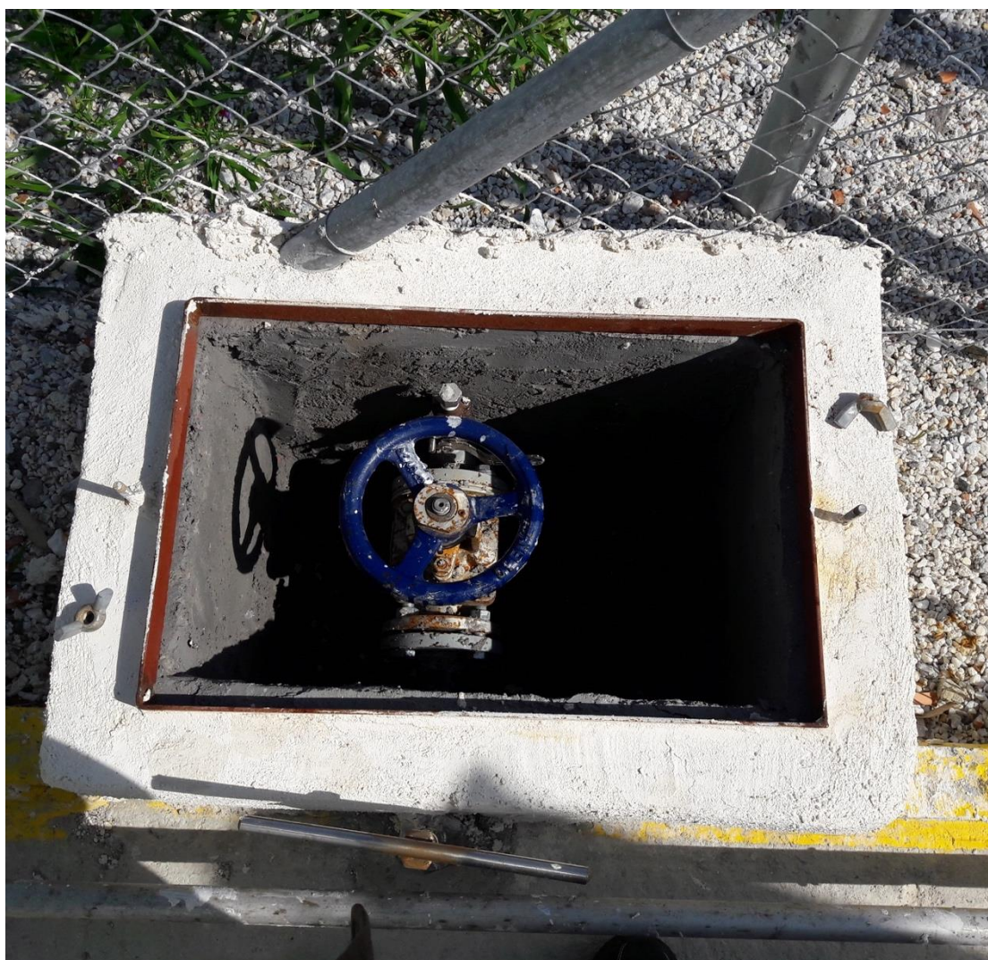
Εικόνα 4.6: Βάνα μέσα σε φρεάτιο για τον βιολογικό καθαρισμό
