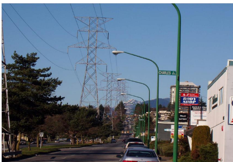
Εικόνα 3. Συνήθης όψη εναέριων γραμμών (Overhead or Underground A Comparison, Harry Orton, OCEI Vancouver, Canada)
