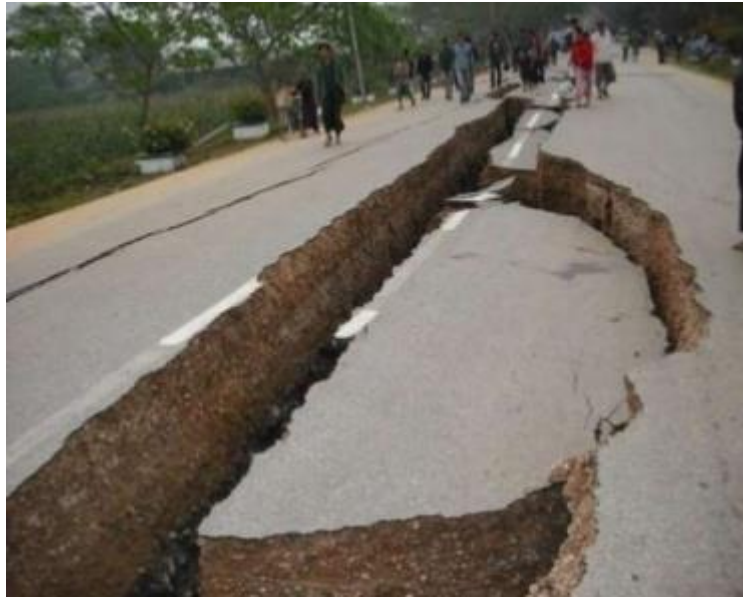
Εικόνα 17. Αστοχία του οδοστρώματος μετά το σεισμό της Λευκάδας 2015
