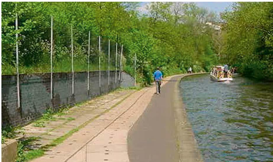
Εικόνα 9. Εγκατεστημένα δίκτυα 275KV κατά μήκος πλωτών επιφανειών (NationalGrid, 2015)
