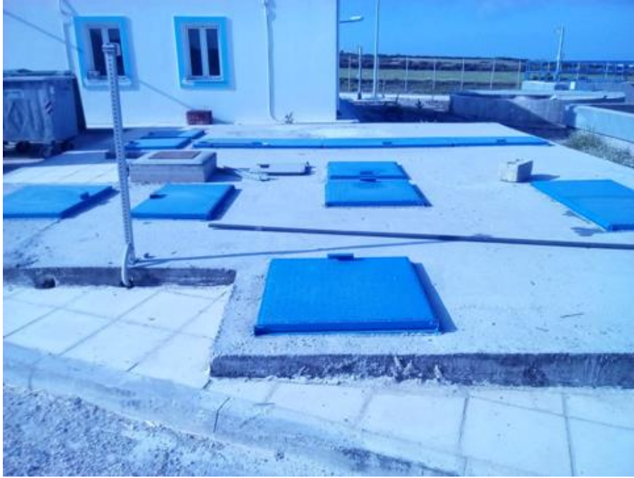
Εικόνα 15. Δεξαμενή Πρωτοβάθμιας Καθίζησης ΕΕΛ Θηρασιάς (Avlonitis, 2018).
