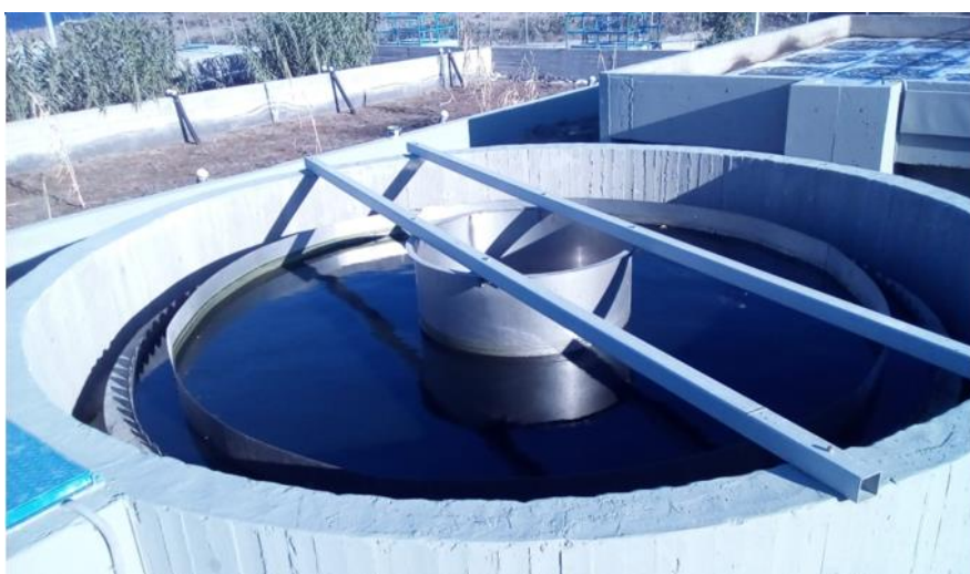
Εικόνα 17. Δεξαμενή Καθίζησης Φωτοκατάλυσης ΕΕΛ Θηρασιάς (Avlonitis, 2018).
