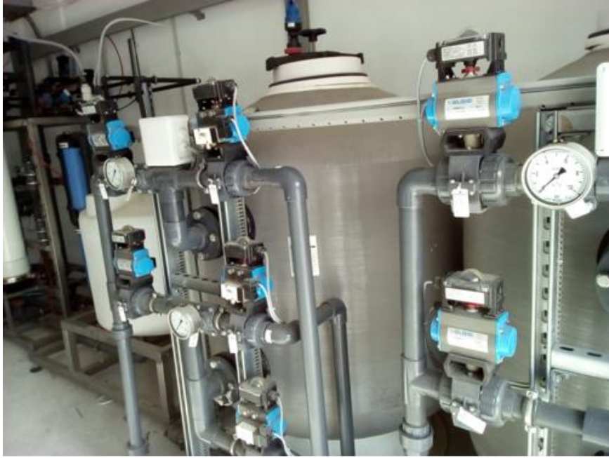
Εικόνα 19. Μονάδα υπερδιήθησης ΕΕΛ Θηρασιάς (Avlonitis, 2018).
