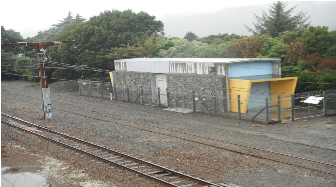
Υποσταθμός έλξης σιδηροτροχιάς Woburn στο Lower Hutt της Νέας Ζηλανδίας, που παρέχει 1500 V DC στην ηλεκτροκίνητη γραμμή Hutt Valley.
