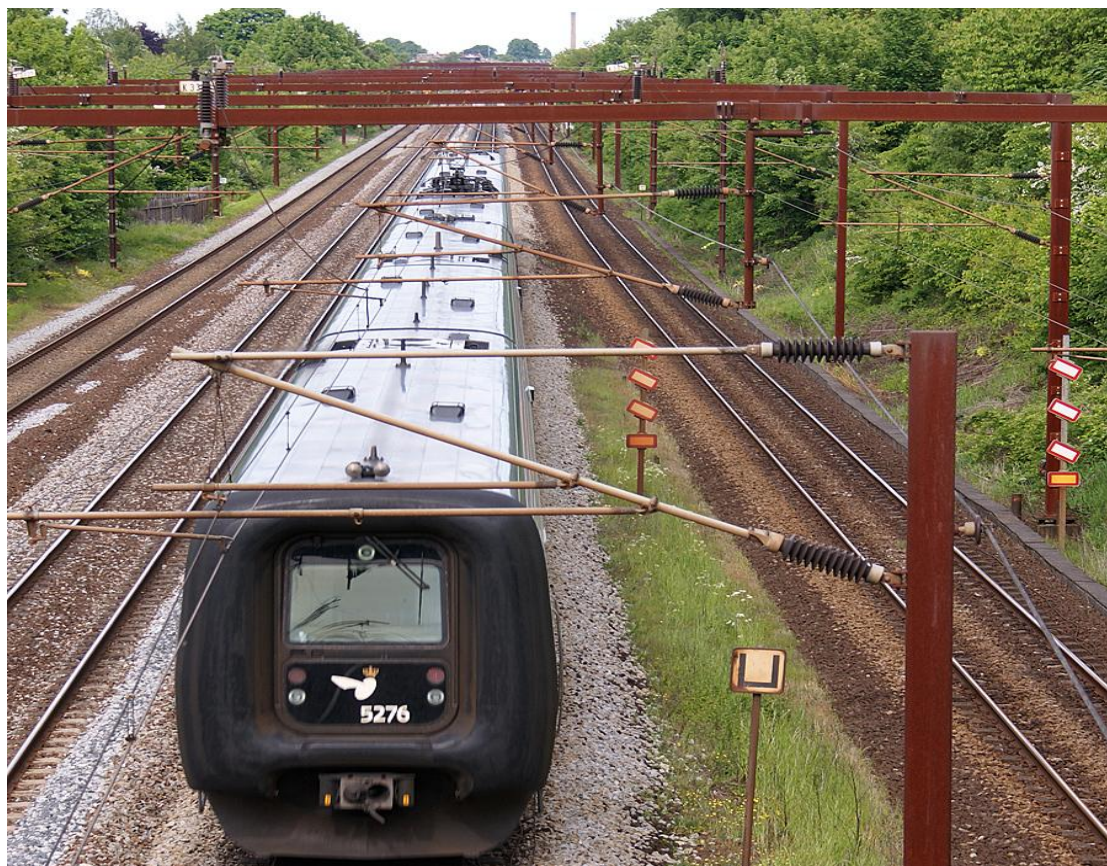
Εναέρια γραμμές στη Δανία κοντά στο Roskilde. Για αισθητικούς λόγους, η δομή στήριξης κατασκευάζεται από κοίλους χαλύβδινους ιστούς COR-TEN.
