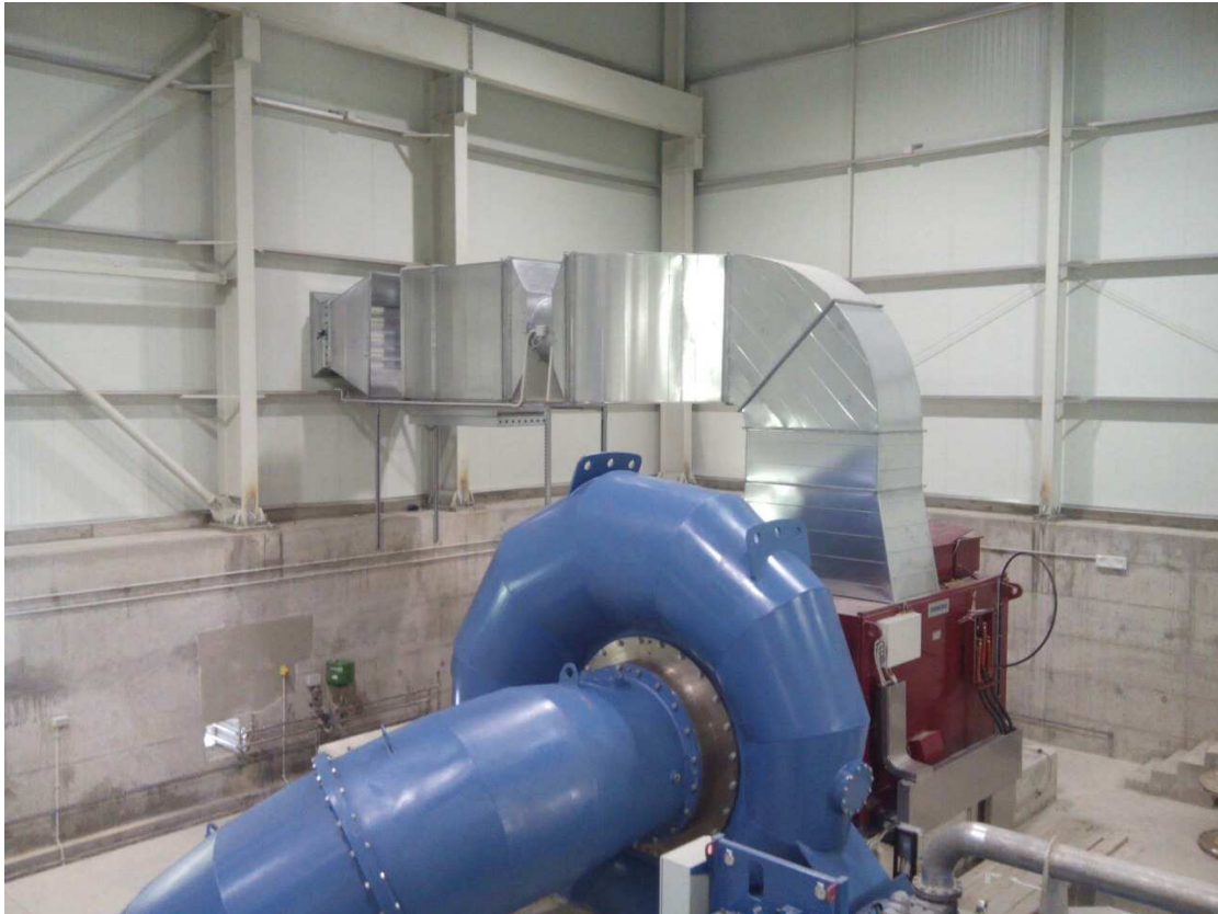
Εικόνα 2.3 Φωτογραφία μίας εκ των τριών ολοκληρωμένων Υδροηλεκτρικών μονάδων του πρότυπου έργου
