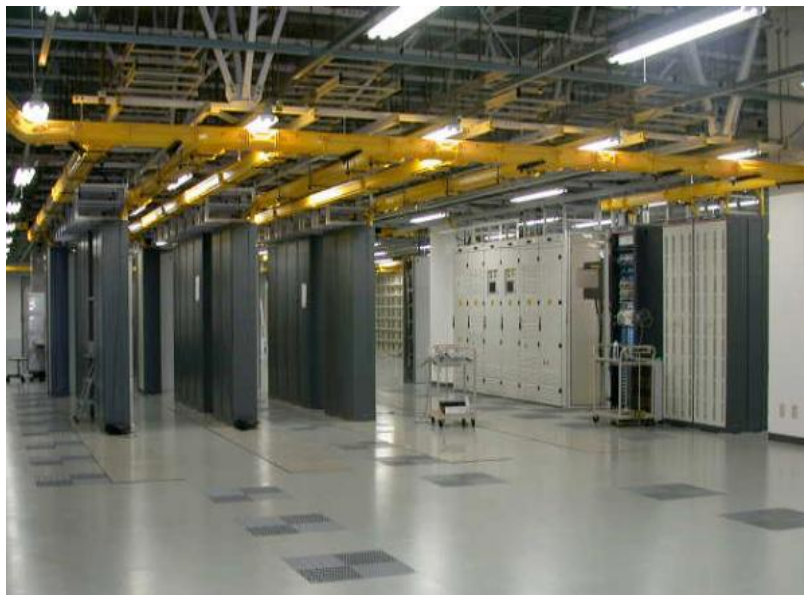
Εικόνα 2.19: Εξοπλισμός τερματισμού της υποβρύχιας γραμμής (SLTE) (στα αριστερά) και Εξοπλισμός τροφοδοσίας ισχύος (PFE) (στα δεξιά). (Πηγή: www.indicomm.co.uk )
