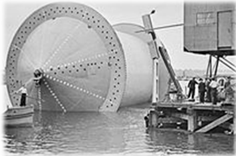
Εικόνα 3.1: Διαδικασία τοποθέτησης του αγωγού. Ο κύλινδρος που απεικονίζεται χρησιμοποιείται για την περιέλιξη του σωλήνα.
