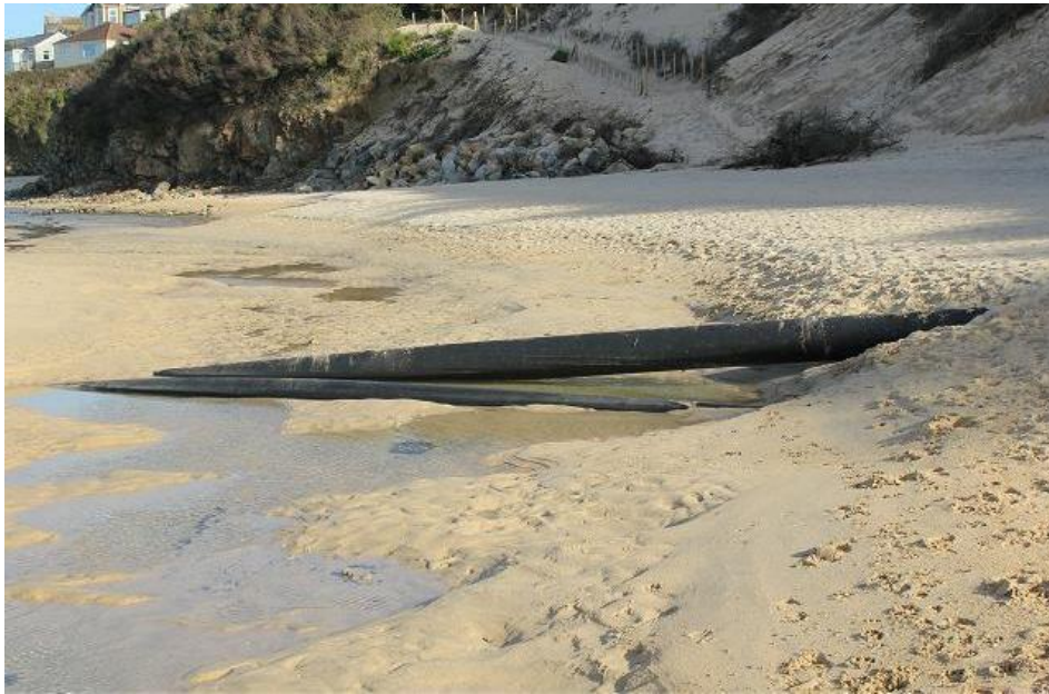
Εικόνα 2.23: Υποθαλάσσιο καλώδιο σε ακτή του Ηνωμένου Βασιλείου εκτεθειμένο στην ακτή εξαιτίας της επίδρασης των θαλάσσιων κυμάτων σε αμμώδη παραλία. (Πηγή: Ardelean and Minnebo, 2015)
