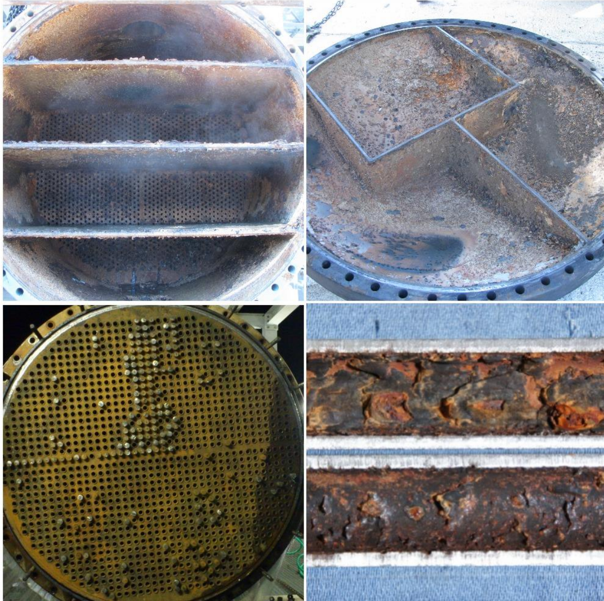
Εικόνα 1-4: Προβλήματα ηλεκτροχημικής βιοδιάβρωσης που οφείλεται στην ύπαρξη μικροοργανισμών σε εναλλάκτες θερμότητας του διωλιστηρίου της Motor Oil Hellas στην Κόρινθο, Ελλάδα.
