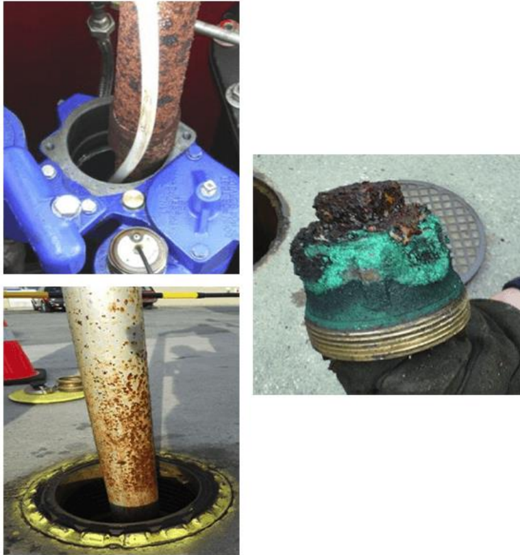
Εικόνα 1-5: Διάβρωση διαφόρων εξαρτημάτων του συστήματος διακίνησης και αποθήκευσης biodiesel.
