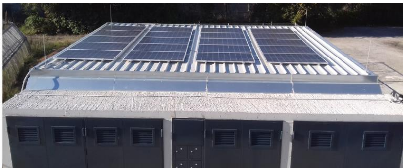
Εικόνα 7.2: Φωτοβολταϊκά πλαίσια στο στέγαστρο του σταθμού φόρτισης
