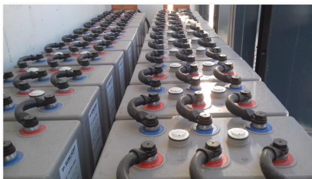
Εικόνα 7.11: Μονάδα αποθήκευσης συσσωρευτών Μολύβδου - Οξέος
