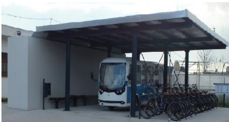
Εικόνα 7.1: Σταθμός φόρτισης ηλεκτροκίνητων οχημάτων ΓΠΑ
