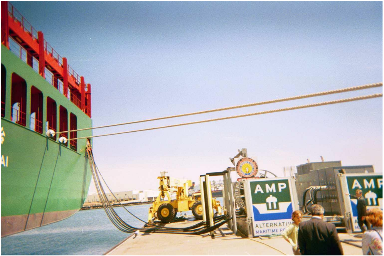
Σχήμα 2.4. Στο σχήμα απεικονίζεται η εγκατάσταση παροχής ενέργειας
