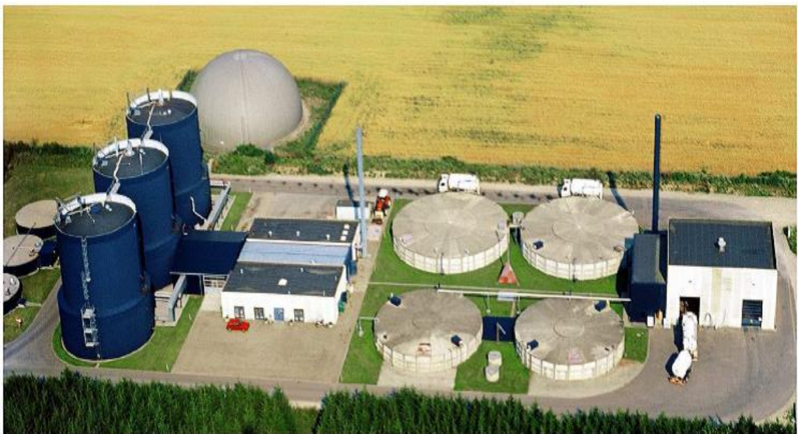
Εικόνα 3.3: Μονάδα παραγωγής βιοαερίου από αστικά απορρίματα
